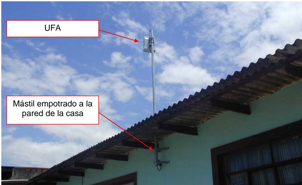
Figura 4.35. Instalación de la UFA.
