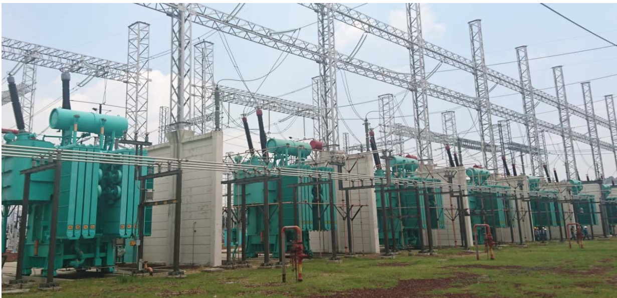
Imagen 3. Bancos de autotransformadores 400/230 kV con bus terciario en media tensión.
