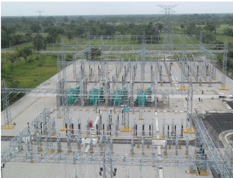
Imagen 1. Subestación Eléctrica 115/230 kV con un banco de autotransformadores.
