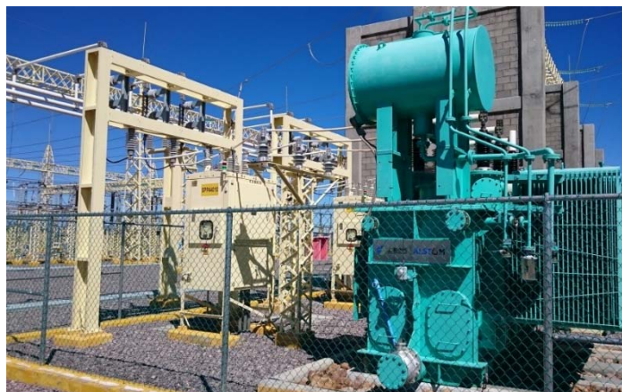
Imagen 4. Equipo de compensación reactiva conectado a bus terciario (detrás se observa interruptor para transformador de servicios propios de la subestación).
