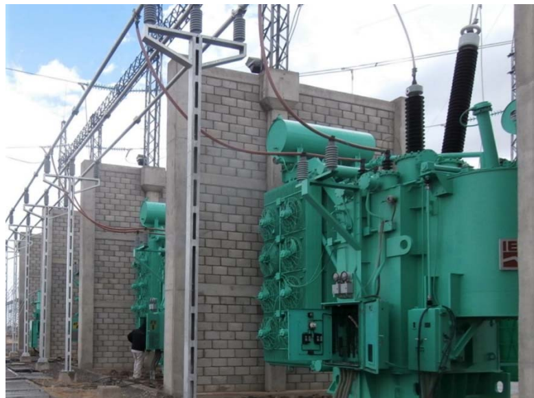
Imagen 2. Autotransformador de potencia con devanado terciario.
