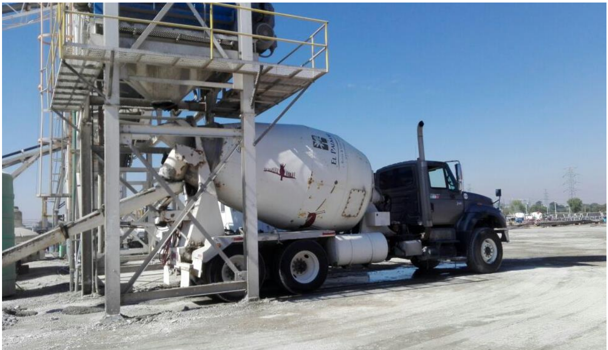
Figura 44. Dosificadora de concreto en PRET La arboleda.
