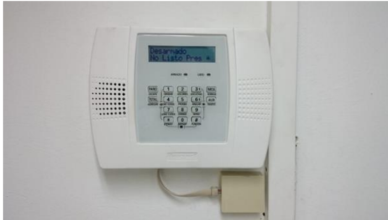
FIG. 5.13 - Panel de control de la alarma en el piso 7.
