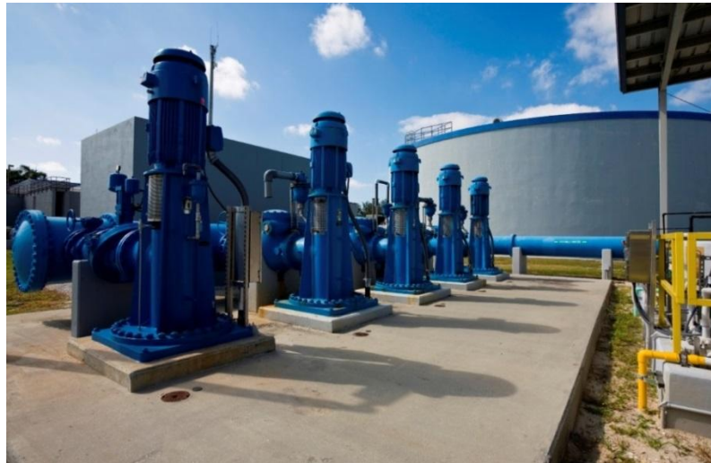
Figura 7 Planta de bombeo de agua 10
