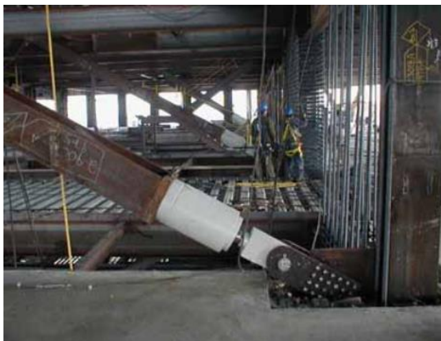
Figura 1.2 Amortiguador instalado en un marco resistente en la Torre Mayor
