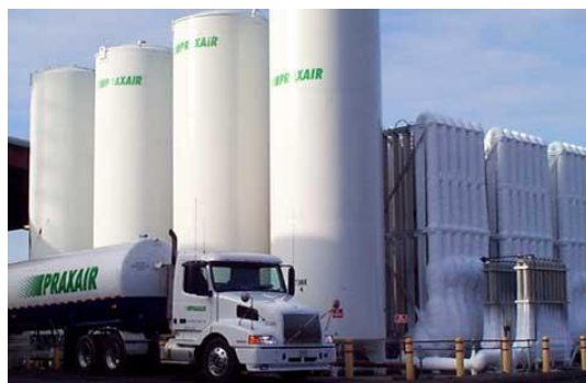
Instalación de gases criogénicos de Praxair
