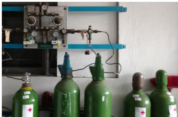
Colector de cilindros medicinales con conectores dañados (debido al riesgo que implica para el usuario se ocupa lo menos posible).
