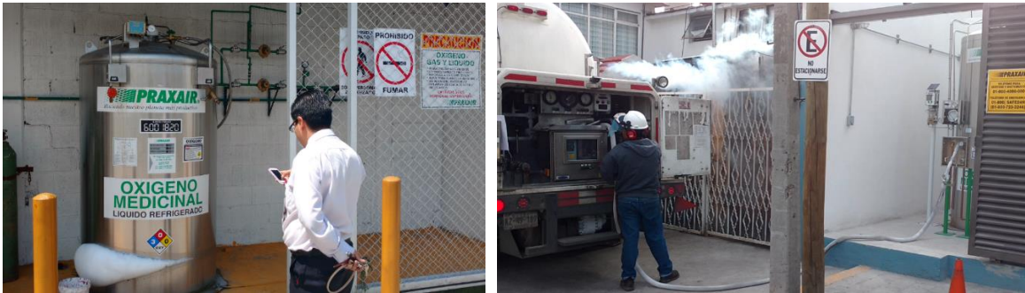
Ejemplo de tanques estacionarios de oxígeno líquido y llenado con pipa de oxígeno líquido.
