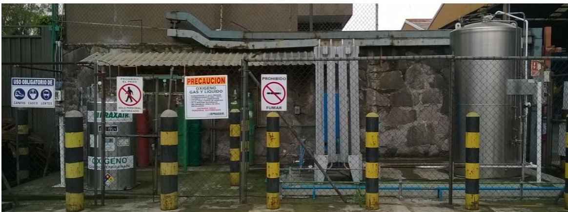
Central de mezcla de gases para fabricación de tanques de gas LP
