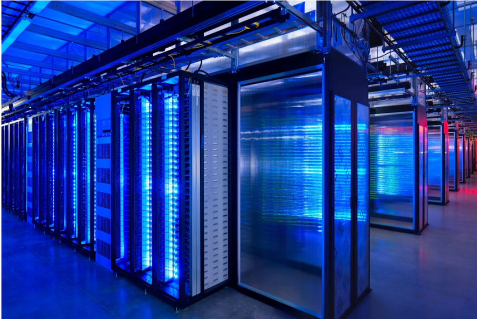
Figura 1.1 Vista interior de un CPD
