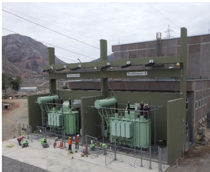
Figura 5. Transformadores de Potencia al exterior de Casa de Máquinas. (1.e)
