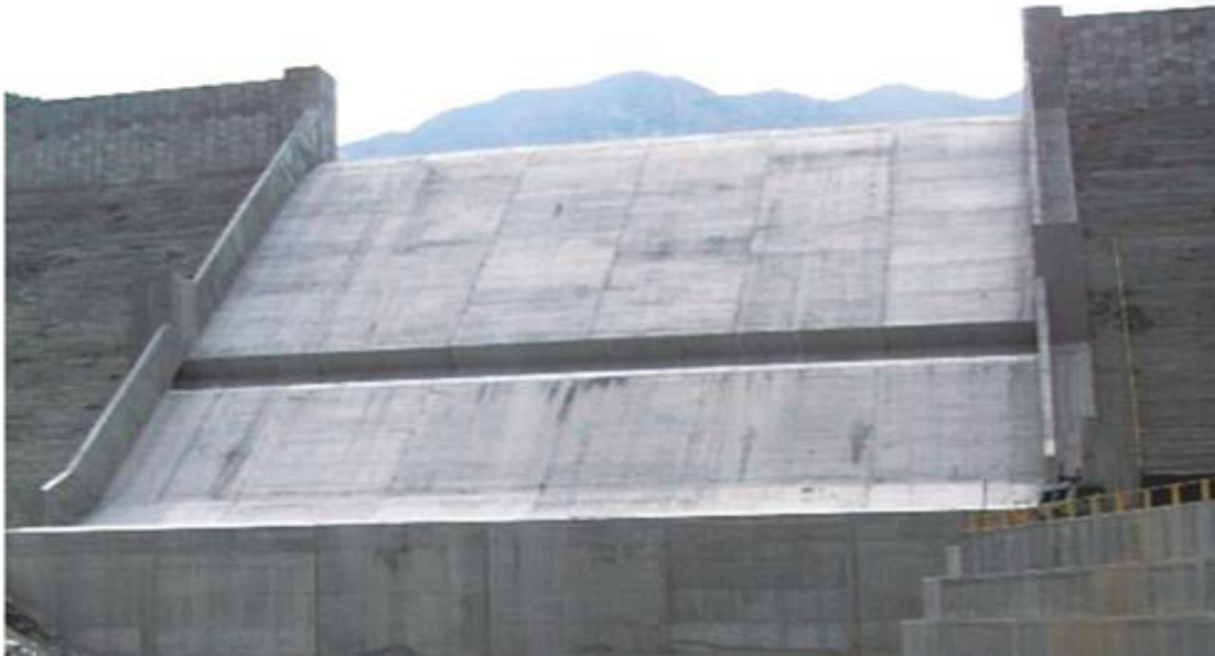
Figura 2.29. Aireador de la presa Corral de Palmas en el estado de Nuevo León.
