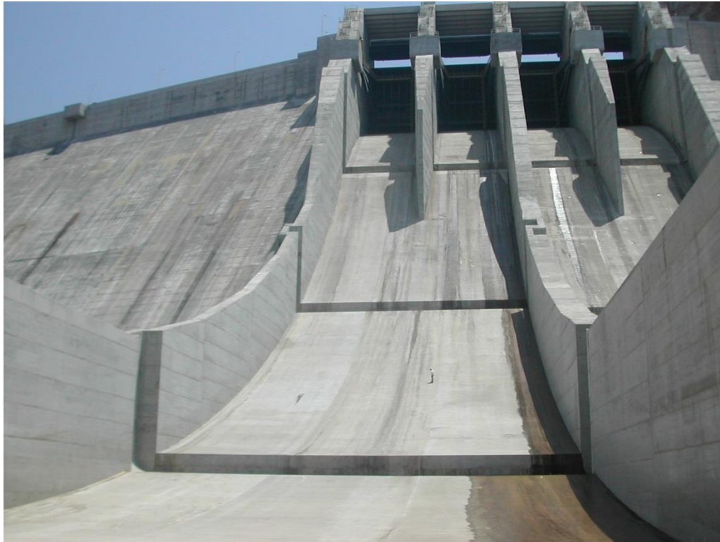
Figura 3.10. Vista frontal de los canales de descarga y aireadores del vertedor de la presa Huites.
