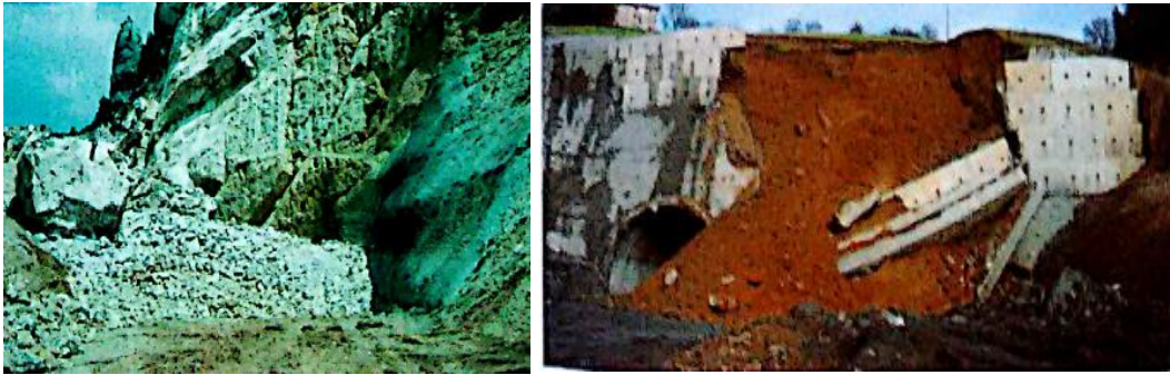
Figura 2-9. Izquierda: Hundimiento de una parte del terreno sobre el túnel en la misma boca. Túnel de Pancorbo. Derecha: Colapso en la misma boca del túnel. Portal Sur. Túneles de Zarimut (Guipuzcoa). Fuente: Romana, 2005.
