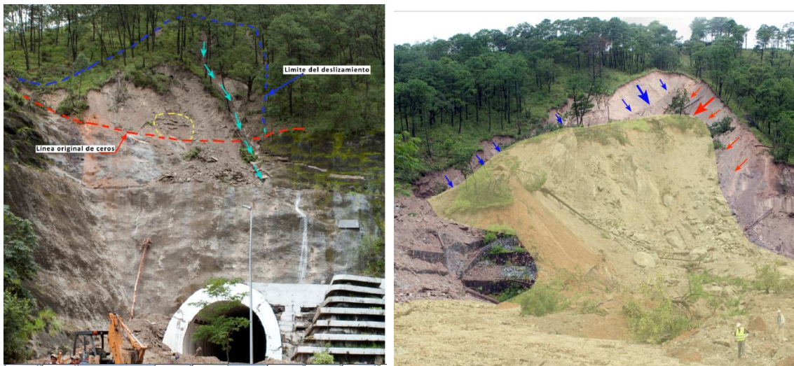
Figura 2-2. Zona del portal México de los túneles Agua de Obispo donde ocurrió el desprendimiento. Fuente: Consultec, 2011
