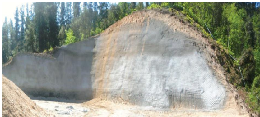
Figura 3-2. Protección del talud con la combinación de anclajes, mallas y concreto lanzado. Fuente: MTC, 2014
