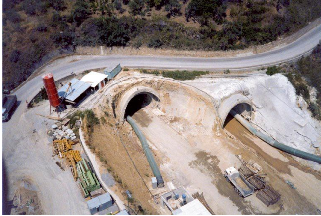
Figura 2-11. Túnel S. Elia (Carretera Messina-Palermo): Portal en Messina bajo construcción. Fuente: Lunardi, 2008
