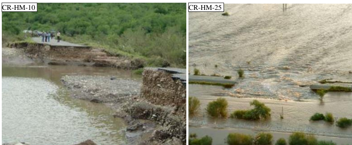
Fig. 4.30. Seccionamientos provocados por corrientes de agua
