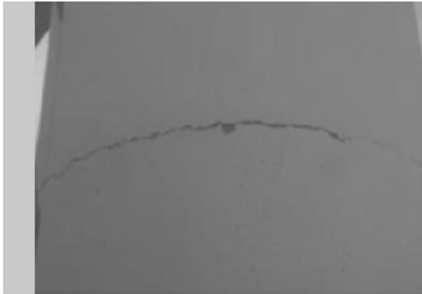
Fig. 4.12. Agrietamiento en columna de puente
