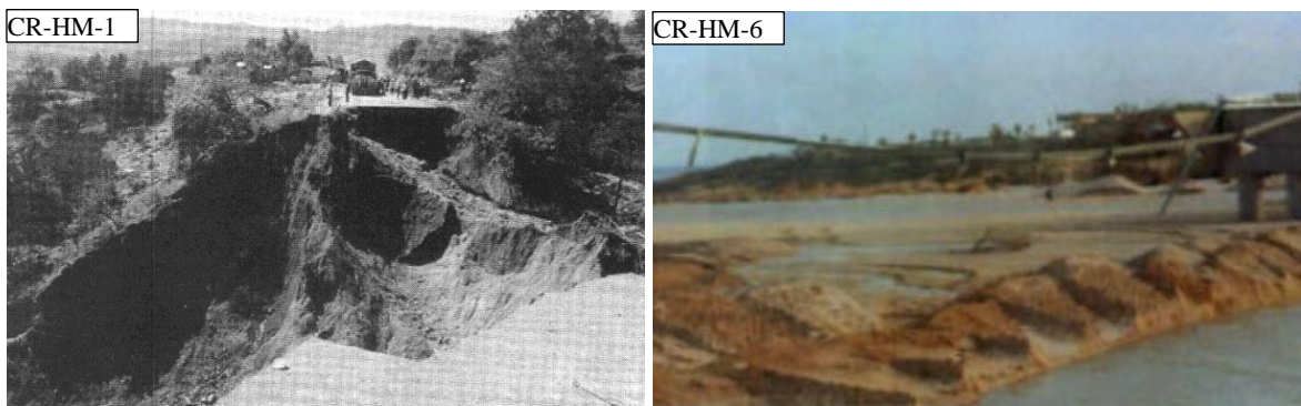
Fig. 4.29. Daños por seccionamiento
