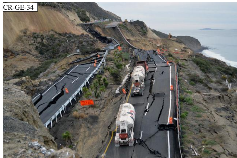
Fig. 4.21. Daños por deslizamiento de ladera
