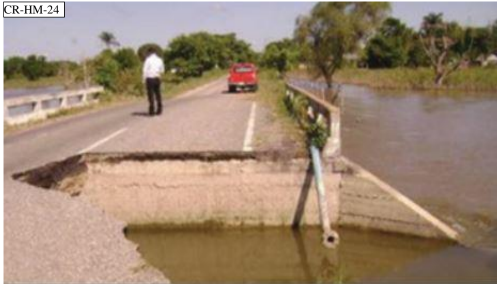
Fig. 4.8. Colapso parcial del terraplén de acceso al puente. Fuente: CENAPRED
