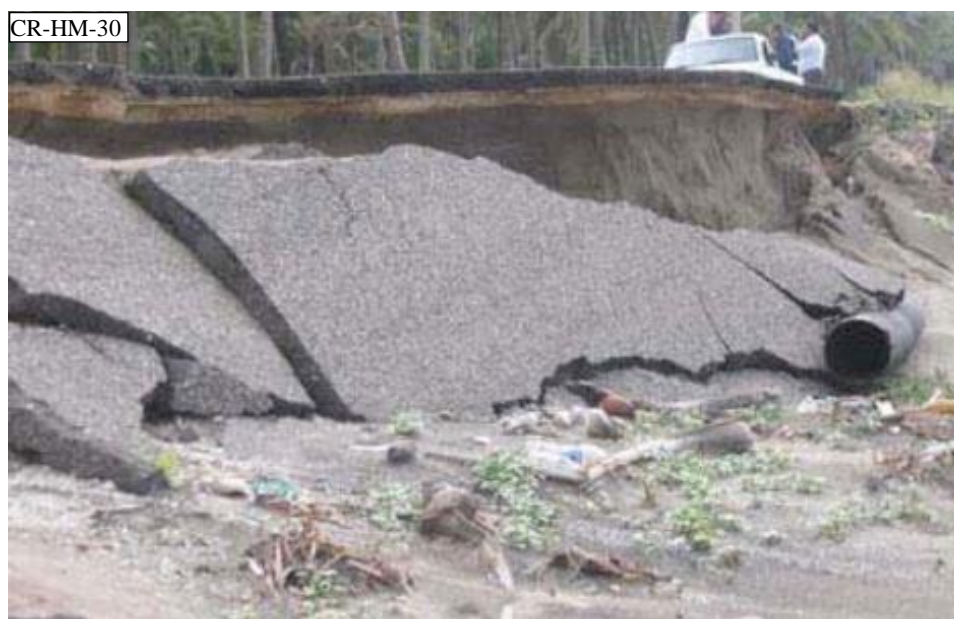
Fig. 4.24. Erosión por oleaje
