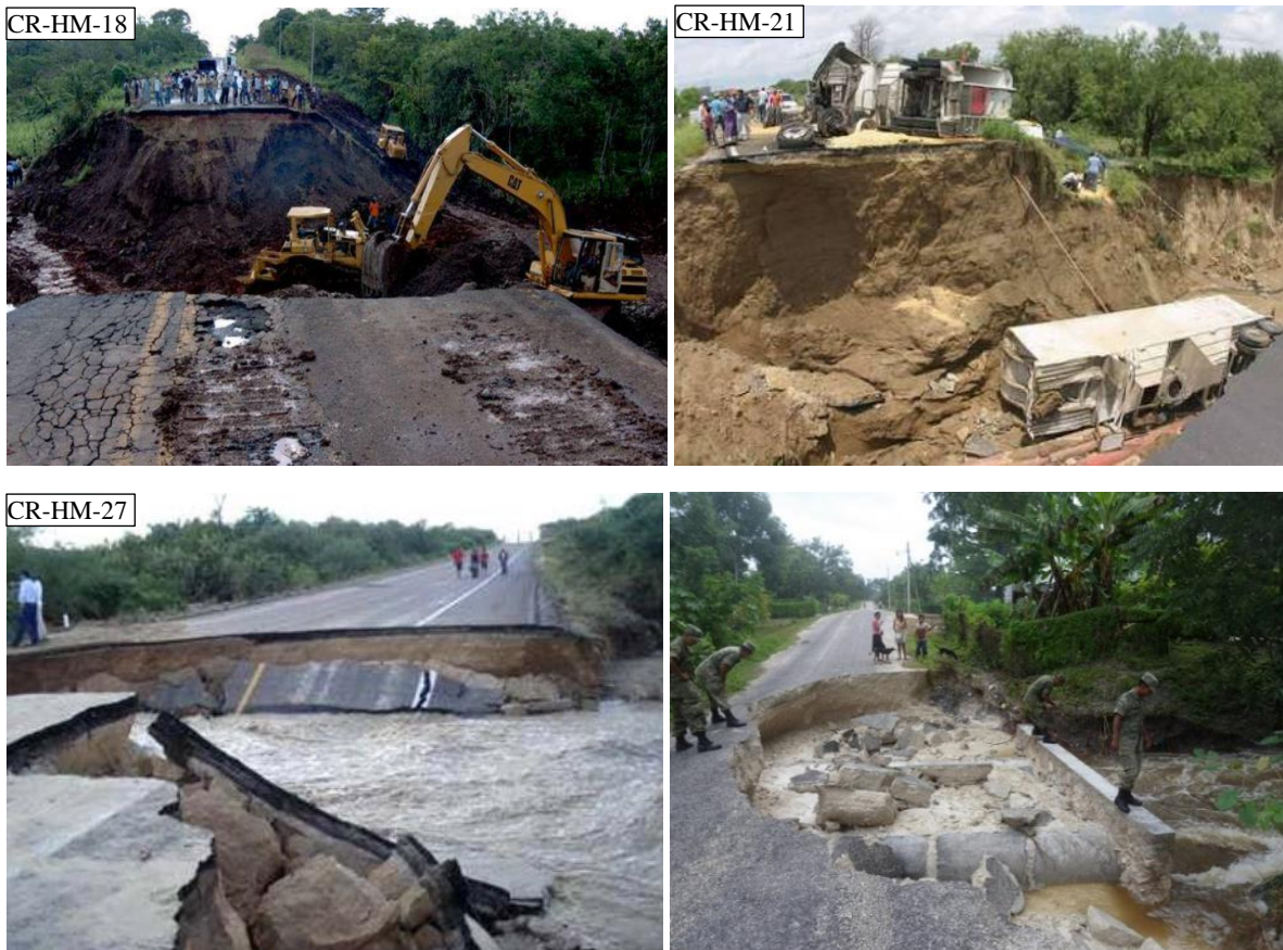
Fig. 4.31. Seccionamientos por falla de alcantarillas
