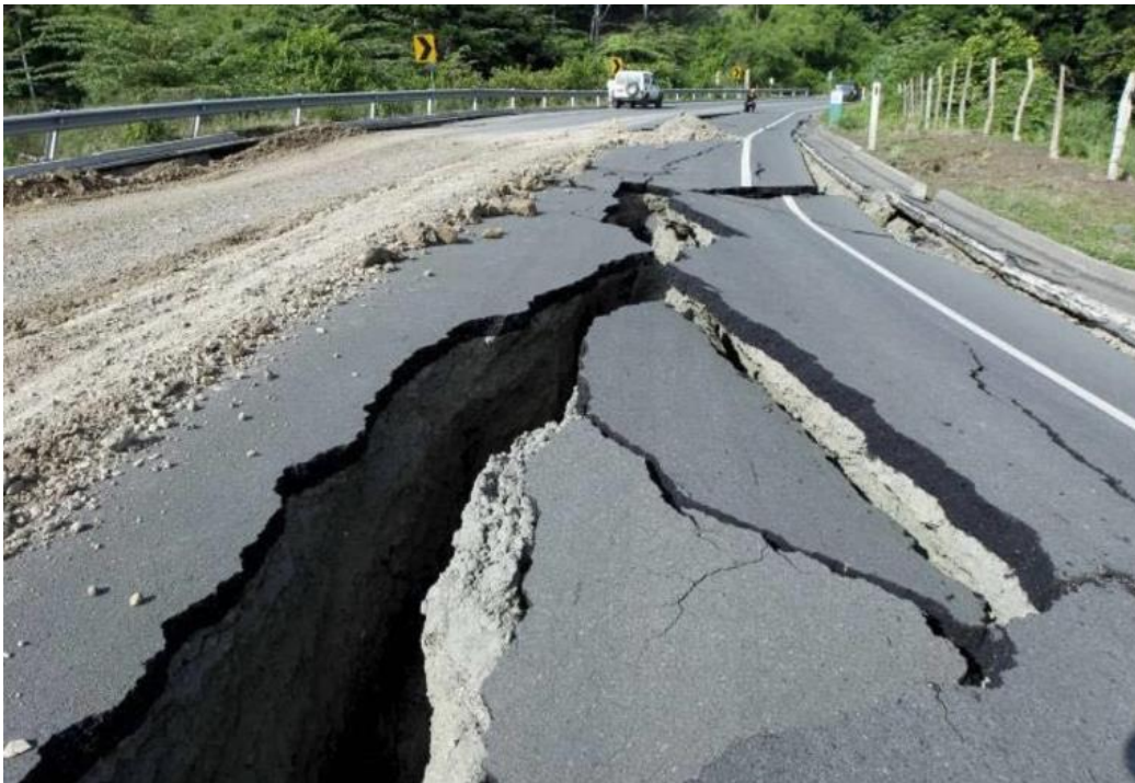
Fig. 4.2. Agrietamientos en estructura del pavimento. Fuente: Televisa News (noticieros.televisa.com)
