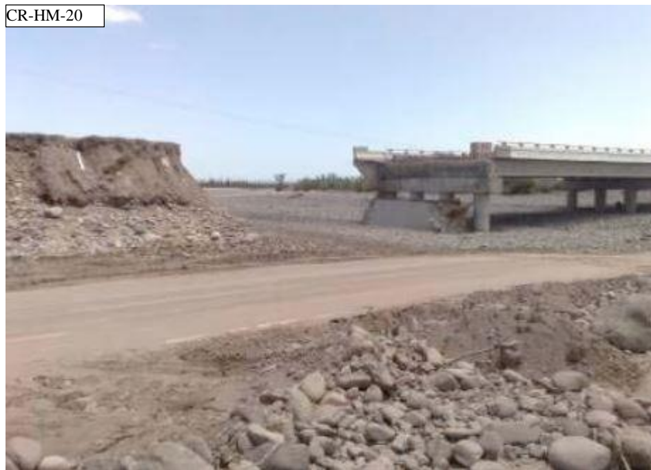
Fig. 4.7. Colapso del terraplén de acceso al puente. Fuente: CENAPRED
