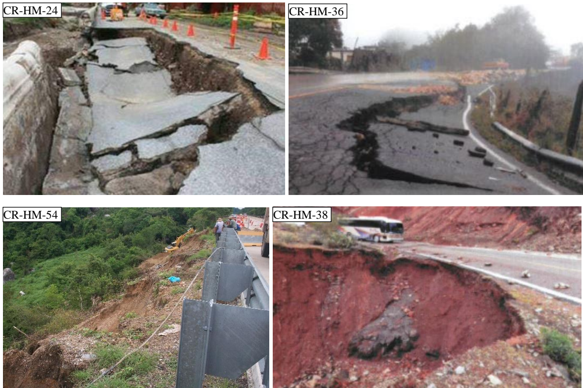
Fig. 4.19. Deslaves por falla de talud en terraplenes
