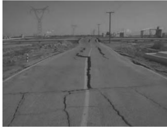
Fig. 4.1. Daño por agrietamiento en pavimento flexible. Fuente: CENAPRED
