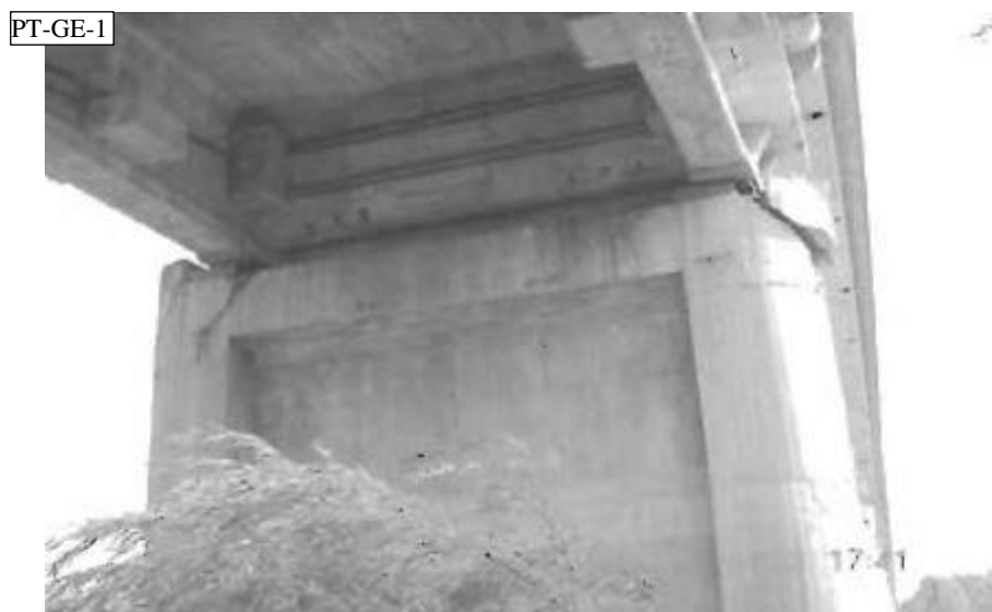
Fig. 4.13. Falla de topes antisísmicos
