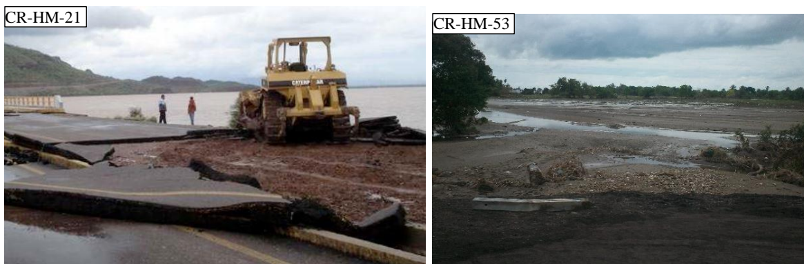
Fig. 4.23. Erosión y destrucción de carpeta asfáltica
