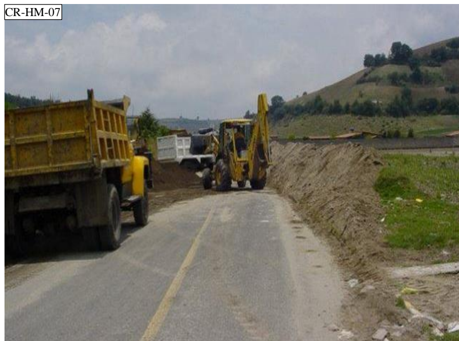
Fig. 4.5. Limpieza de vado afectado por azolve
