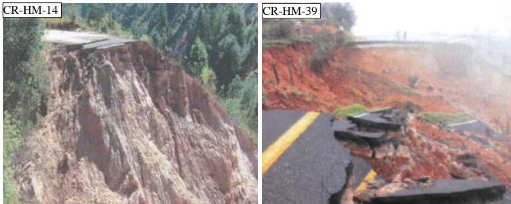
Fig. 4.20. Deslave por falla de talud en corte y terraplén.
