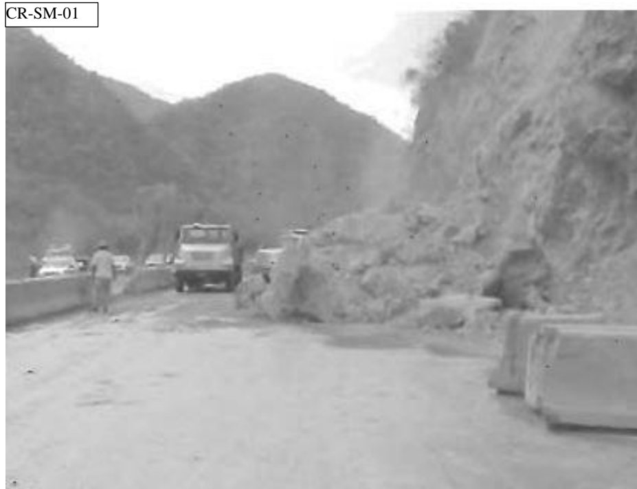
Fig. 4.14. Tramo afectado por derrumbe del corte adyacente. Fuente: CENAPRED
