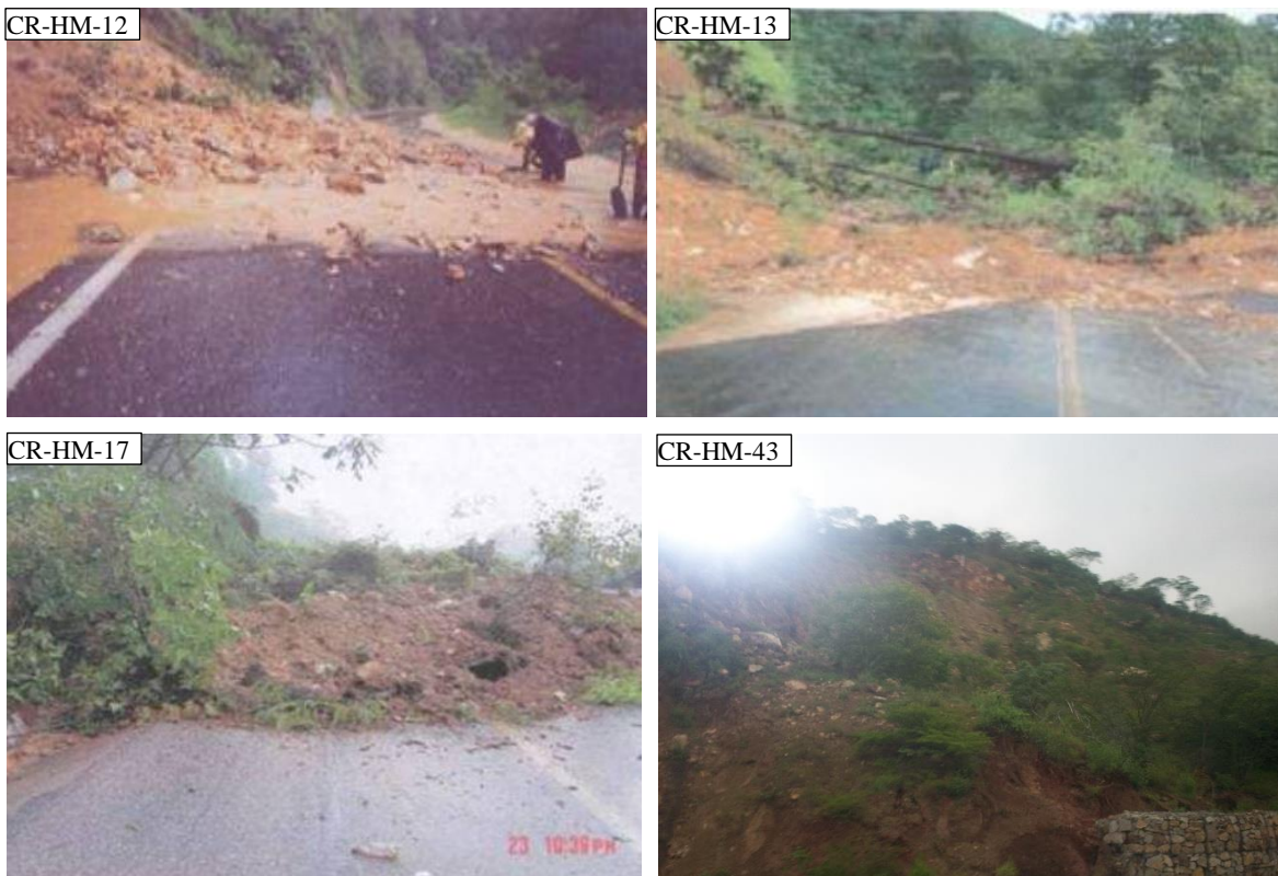
Fig. 4.16. Deslaves por falla de talud en cortes
