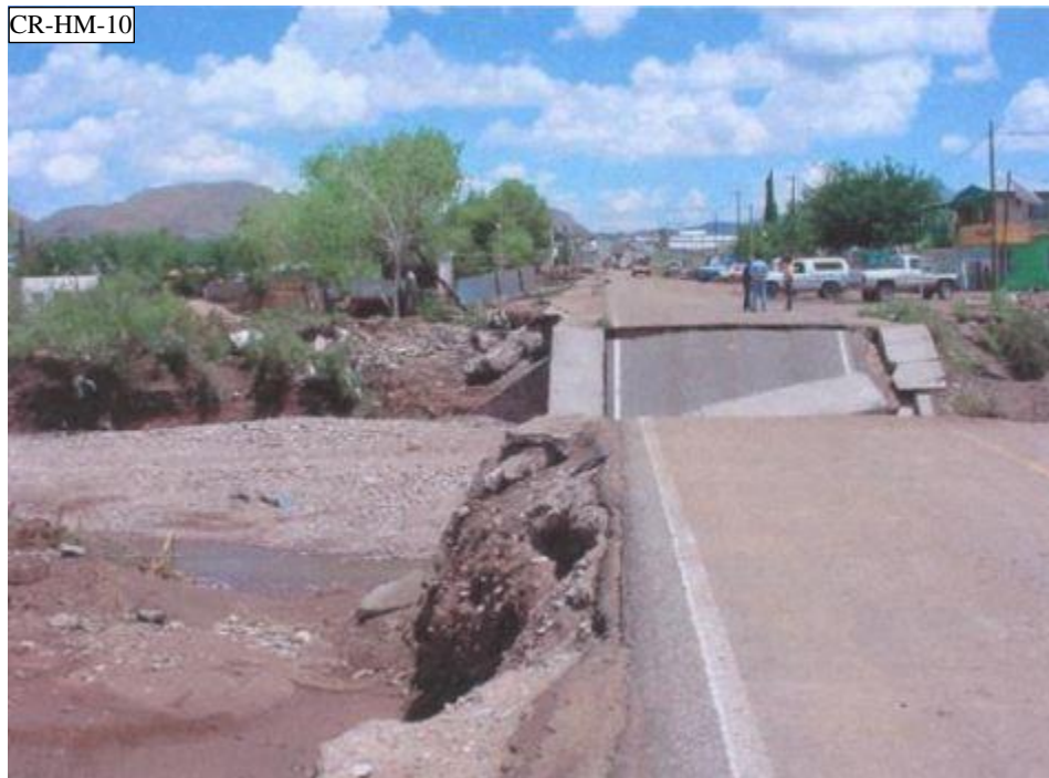
Fig. 4.6. Colapso de puente por falla en apoyos
