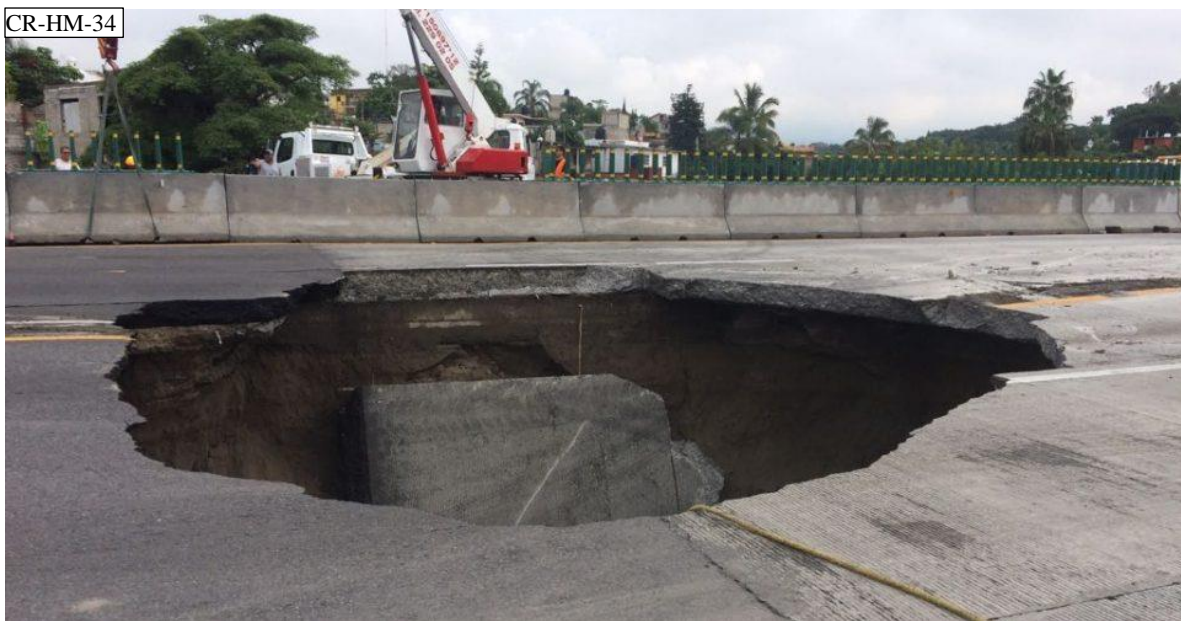
Fig. 4.32. Daño por socavón en el Paso Exprés de Cuernavaca en el km 93+600. (Fuente: animalpolitico.com)
