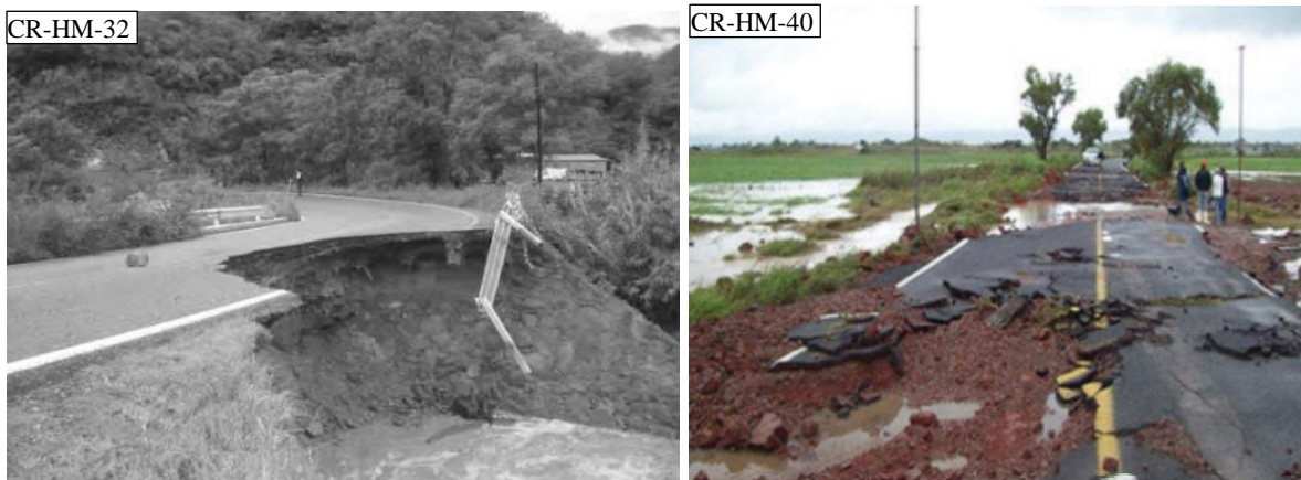
Fig. 4.22. Daños por erosión
