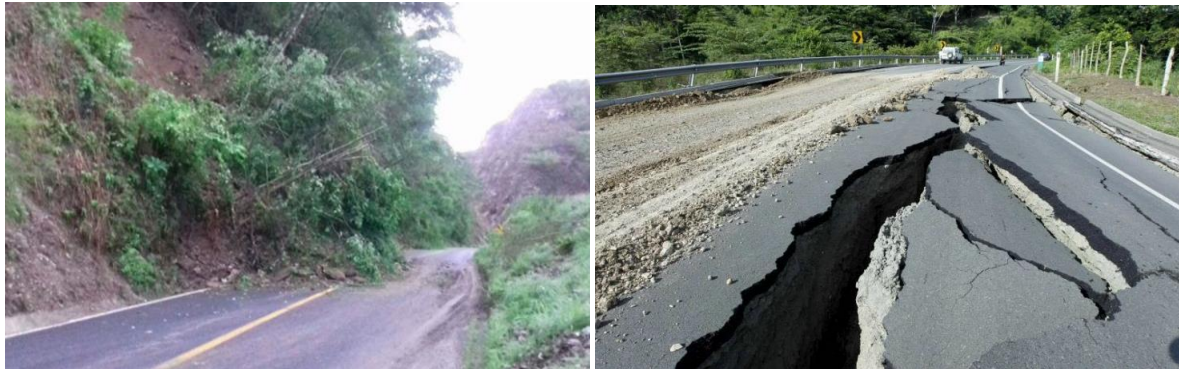
Fig. 3.5. Niveles de daño: Izquierda: “Bajo”; Derecha: “Grave” (Fuente: diariotiempo.mx; ejecentral.com.mx)
