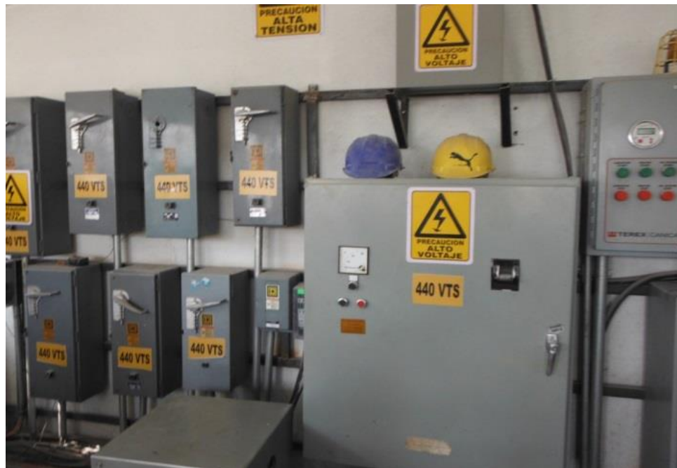
Imagen 10: Suministro de energía eléctrica en la planta JAEM (Fotografía propia)
