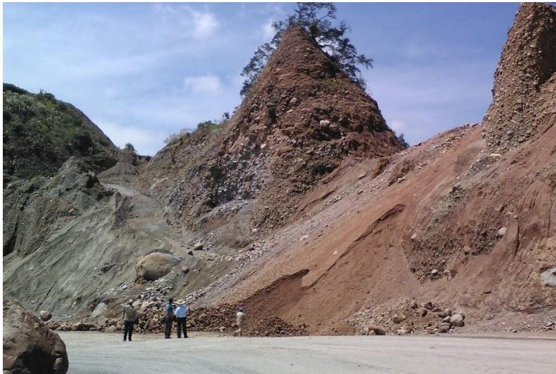
Figura 4.2: Material altamente deleznable de “Lote 4”. Fotografía tomada en septiembre 2016
