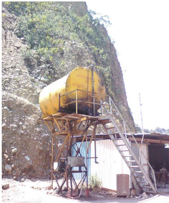
Figura 9.1: Depósito de combustible en mala ubicación, a pies del cuerpo mineral “Lote 4”, con riesgo de ser cubierto por un deslave. Septiembre 2016
