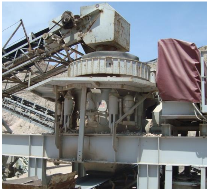
Figura 4.7: Trituradora de cono. Fotografía tomada en septiembre 2016
