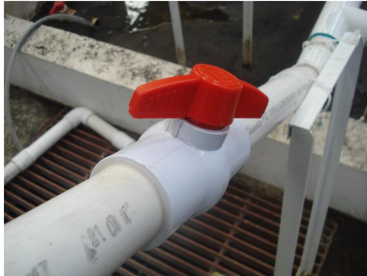
Figura 6. 11 Válvulas de globo de 1 ½" en líneas de alimentación.
