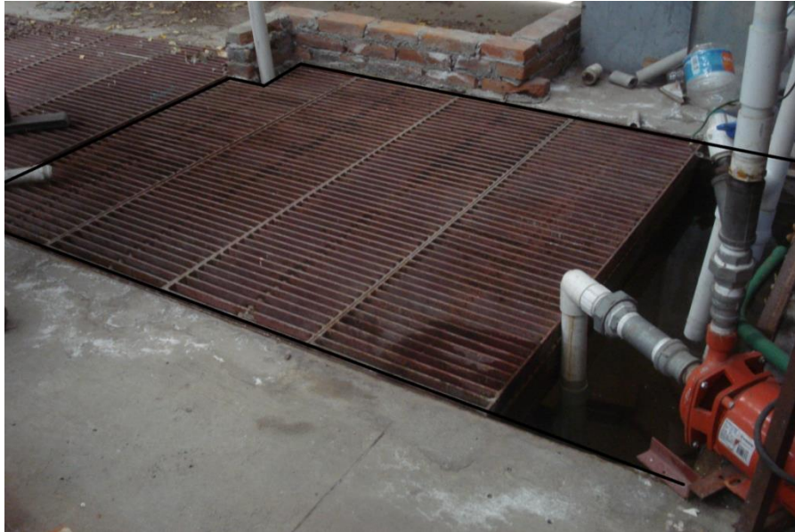
Figura 6. 1 Cárcamo de bombeo, con capacidad de 2.17 m 3
