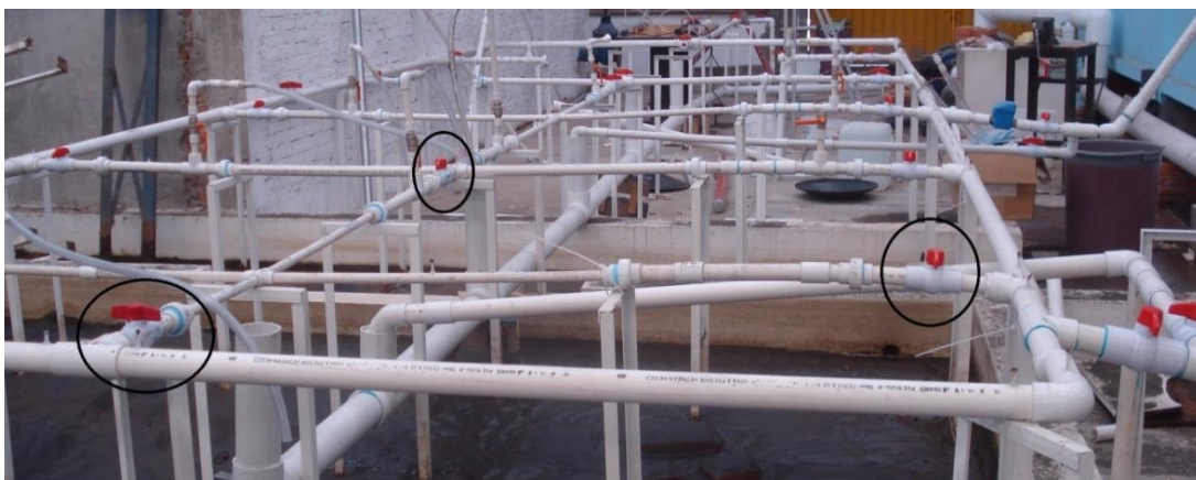
Figura 6. 4 Válvulas de 1" que facilitan las condiciones de mezcla de flujos en cruces de tuberías.
