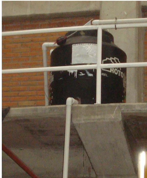
Figura 6. 2 Depósitos con capacidad de 450 L, que alimentan el sistema de tuberías
