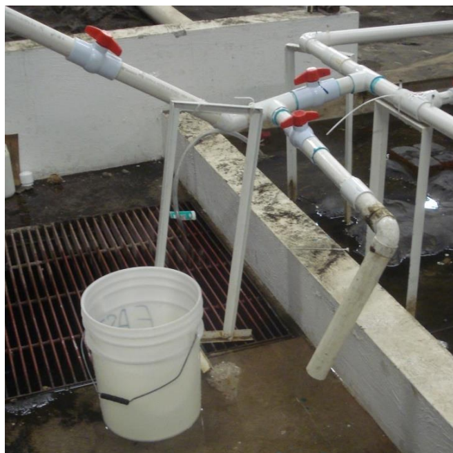
Figura 6. 16 Medición de gasto en líneas de alimentación
