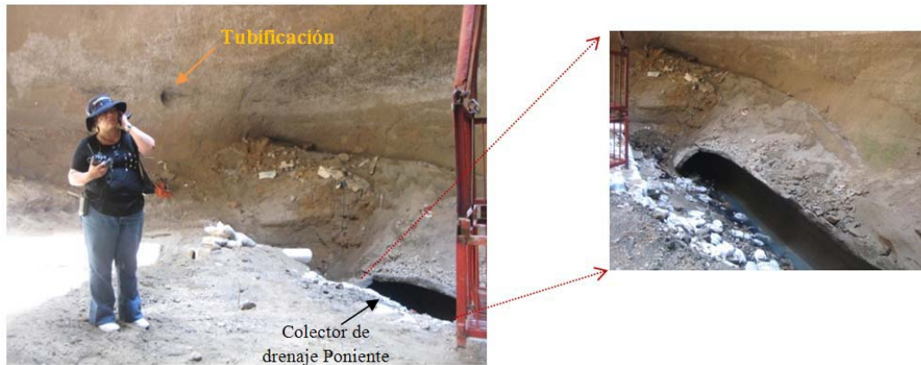
Figura 5.9. Hundimiento de 2010. Fotografía tomada a 48 m de profundidad. Muestra la presencia de tubificaciones y el estado del Colector de drenaje Poniente.
