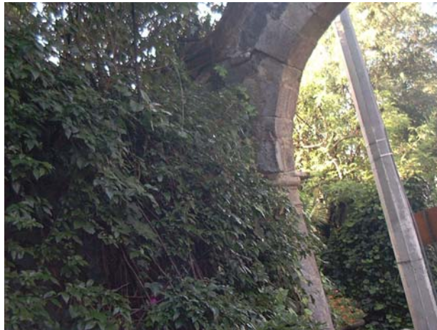
ARCOS DESPLAZADOS (APOYO SUR) FOTOGRAFÍA 4.13
