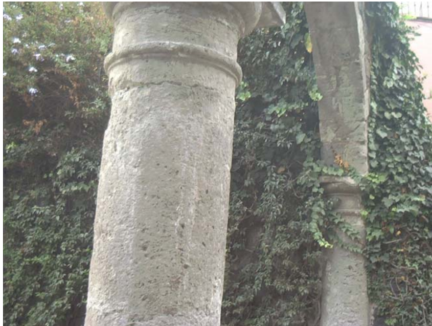
DESPLOME DE LA COLUMNA CENTRAL (FOTOGRAFÍA TOMADA DESDE EL LADO ORIENTE) FOTOGRAFÍA 2.2
