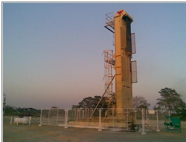
Figura 2.1. Unidad de bombeo mecánico de carrera larga
