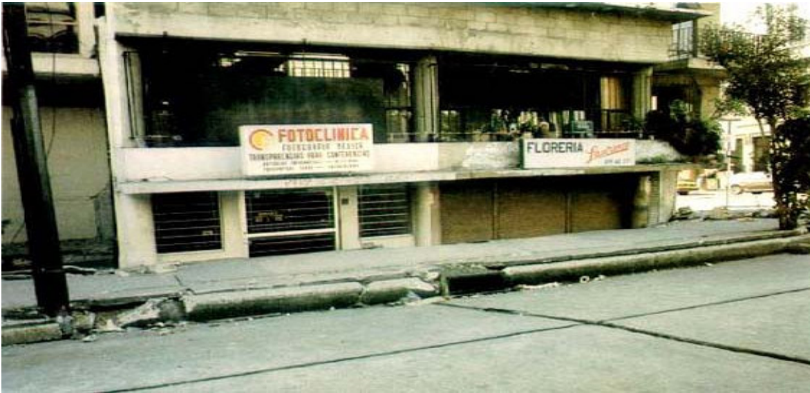
Foto 4.1 Falla local de la cimentación de un edificio en la Ciudad de México en el sismo del 19 de septiembre de 1985.
