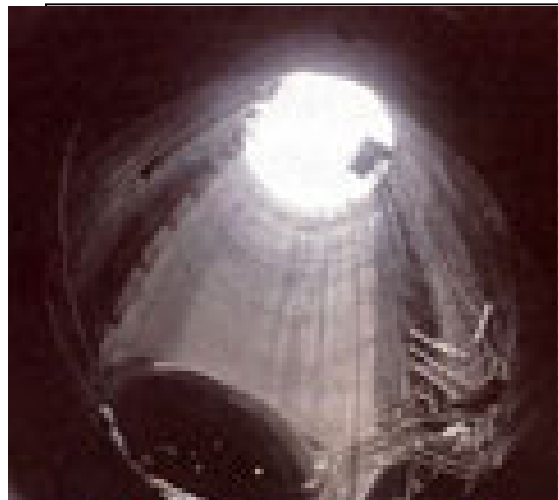
FIGURA 1.7 LUMBRERA DE VENTILACIÓN EN LA ESTACIÓN AUDITORIO L - 7
