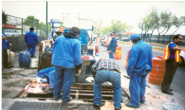
FIGURA 4.9 a, b SE APRECIA EL CAOS VIAL QUE SE GENERA AL CERRAR PARCIALMENTE UNA AVENIDA PRINCIPAL PARA LA REPARACIÓN URGENTE DE LA REJILLA.
