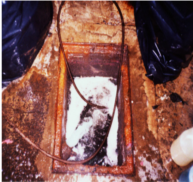
FIGURA 4.5 REGISTRO DE CONDUCCIÓN DE AGUAS PLUVIALES AZOLVADO Y TAPADO.
