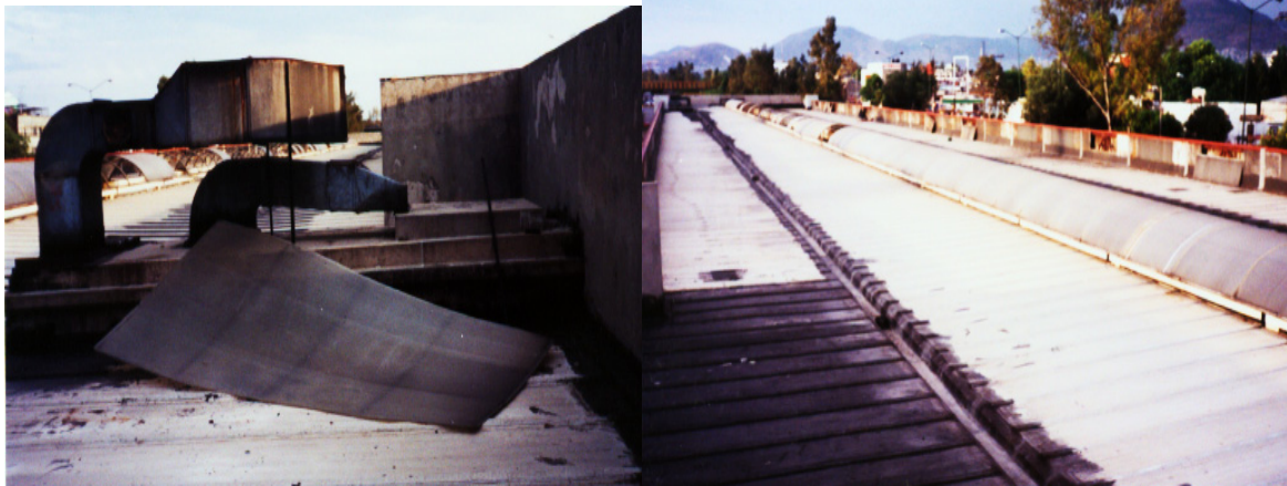
FIGURA 4.1 A MUESTRA EL MAL ESTADO DE LOS DOMOS Y AZOTEAS DE LAS ESTACIONES SUPERFICIALES DE LA LÍNEA 5
