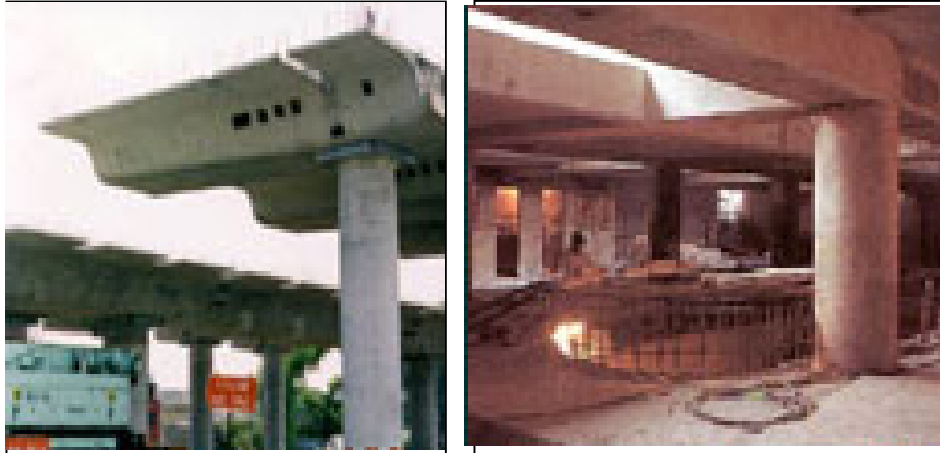
FIGURA 1.11 CONTRUCCION DEL TRAMO ELEVADO DE LÍNEA B EN SU INTERSECCIÓN CON UN PUENTE VEHICULAR.
