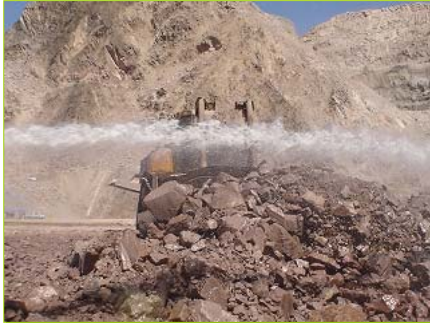
Fotografía III.9. Mediante el uso de tractor, se dispone el material con el espesor especificado. Continúa la humectación.
