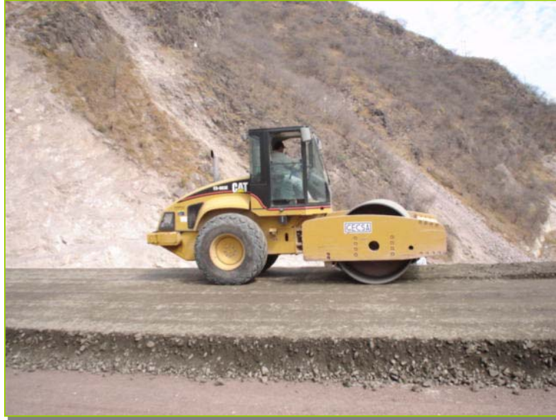
Fotografía III.4 FINALMENTE, EL COMPACTADOR DE RODILLO LISO VIBRATORIO, PROPORCIONA EL GRADO DE COMPACTACION SOLICITADO.
