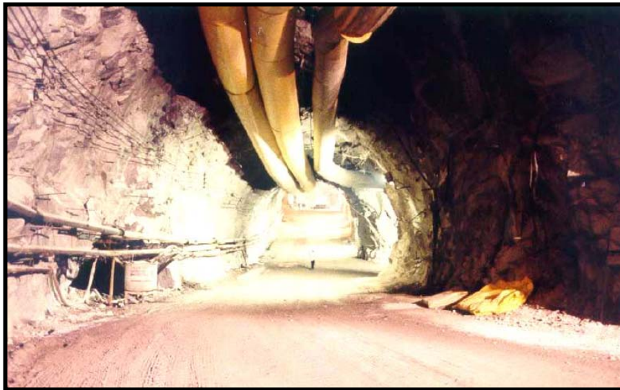
Fig.III.77.-Túnel de acceso a casa de máquinas y bifurcación a túneles auxiliares
