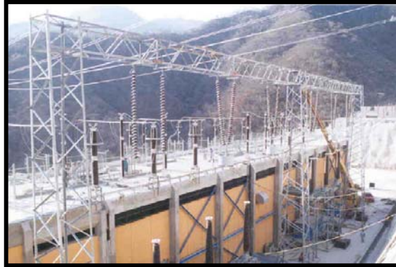
Fig.III.112.-Disposición de los equipos exteriores de la subestación de 400 kV en SF 6
