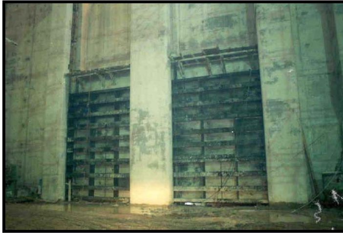
Fig.III.100.-Compuertas en pozos de oscilación
