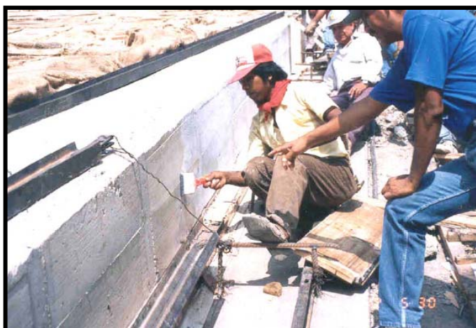
Fig.II.25.- Junta vertical tipo 3 central en la cara de concreto de la cortina. Nótese la plantilla para el asiento de los sellos de cobre y PVC
