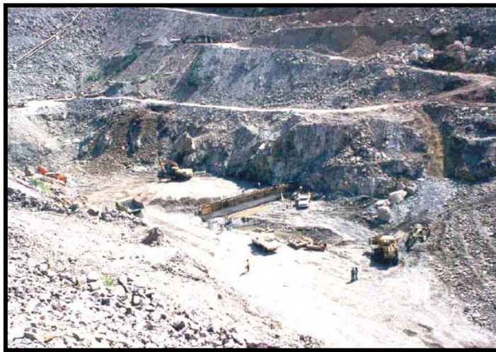
Fig.II.2.- Proceso de construcción del cárcamo de bombeo y limpieza del recinto de la cortina con retroexcavadoras
