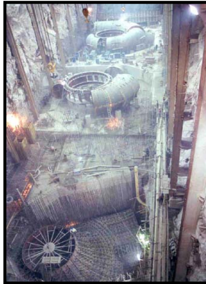
Fig.III.105.-Vista general de casa de máquinas, obsérvese el tubo de aspiración en una unidad, la carcasa-antedistribuidor en otra, y al fondo la carcasa espiralantedistribuidor
