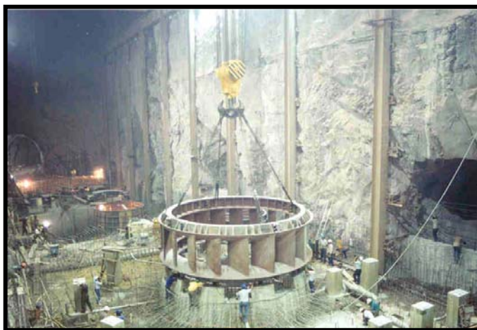
Fig.III.104.-Montaje del antedistribuidor en su sitio en una de las unidades de casa de máquinas
