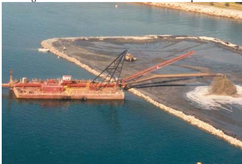
Figura 5.1. Vertido a recinto mediante impulsión.
