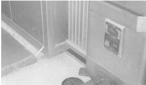
Figura 2.32 Movimiento horizontal de la subestación eléctrica provocado por el sismo
