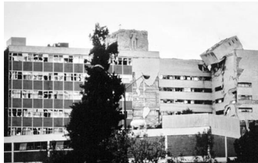
Figura 4.5 Concentraciones de masa, tales como estanques de agua en el techo de hospitales pueden producir daños que comprometan el funcionamiento del hospital
