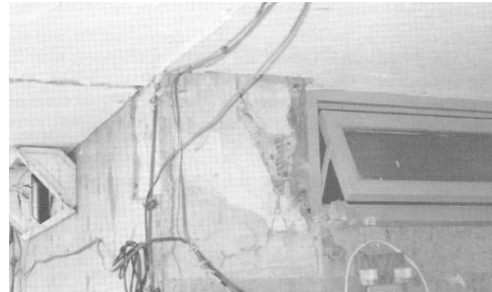
Figura 2.33 Daño en columnas del cuarto de control por efecto de columna corta
