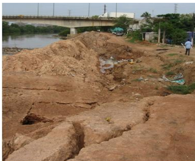
Figura 4.14 Falla de talud favorecida por sobrecarga del bordo, erosión al pie y condición de vaciado rápido en suelo medianamente blando. (Auvinet et. al. , 2008)
