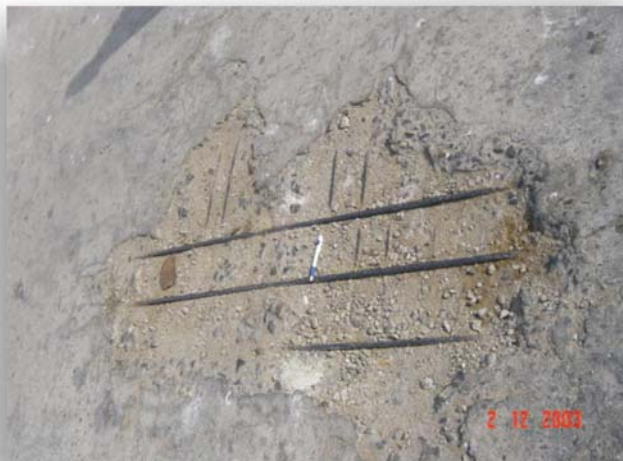
Figura I. 4 Carpeta dañada muelle 90
