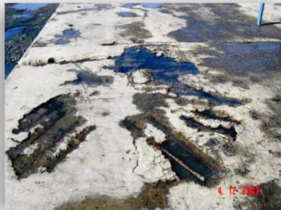
Figura I. 43 Carpeta dañada en muelle 2
