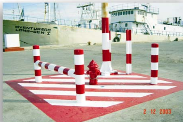
Figura I. 15 Instalaciones contra incendios en muelle 240
