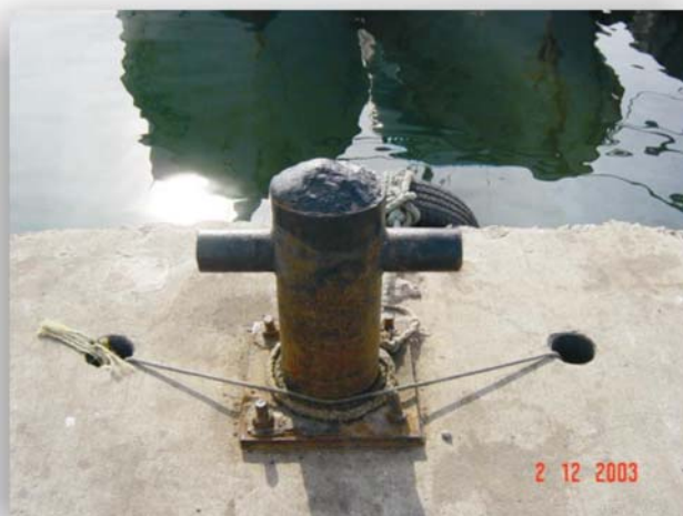
Figura I. 5 Bitas originales en muelle 90
