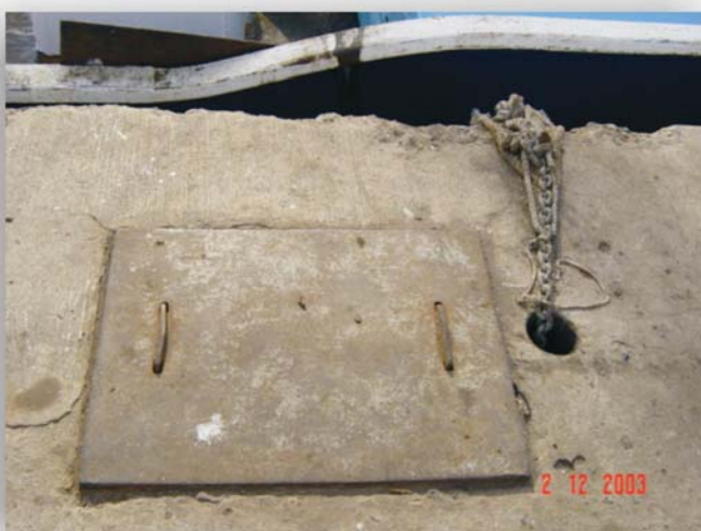
Figura I. 9 Instalación eléctrica en muelle 90
