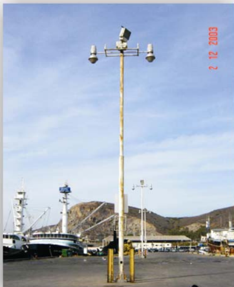
Figura I. 14 Instalaciones de alumbrado en muelle 240
