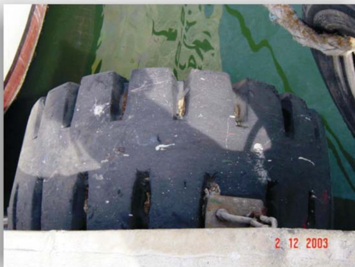
Figura I. 18 Defensas en muelle 240
