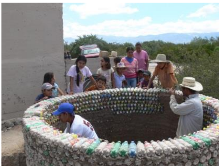
Figura 6-17 Cisterna de 6,000 lts. Construida con botellas de PET, ejido Las Margaritas, estado de San Luis Potosí.
