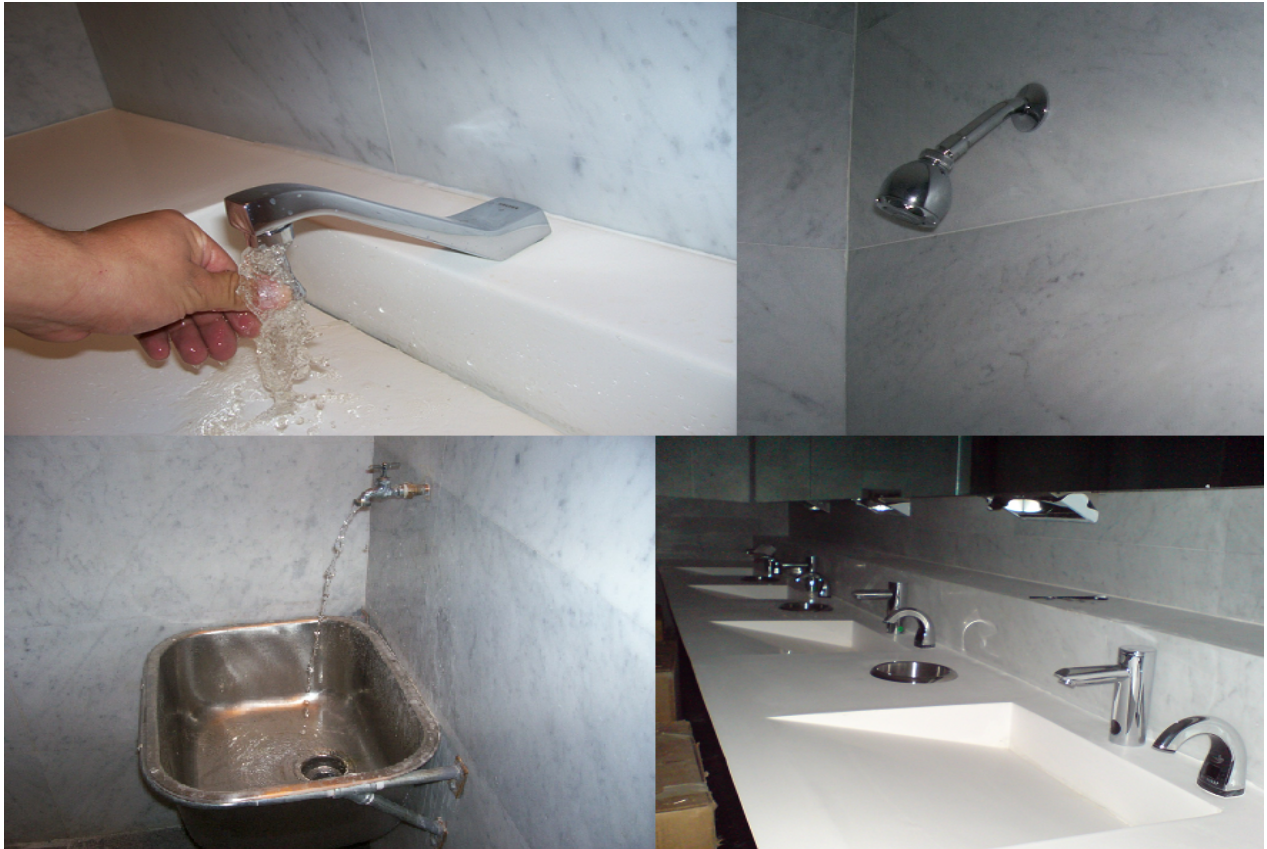
Fotografía 4. Elementos y accesorios de agua potable donde se producen aguas grises
