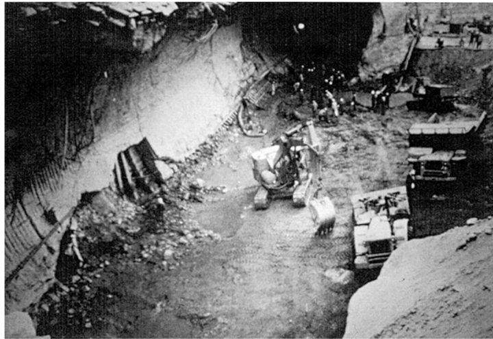
Figura 2.3. Daños por cavitación en el túnel de la presa Tarbela (Lewin, 2001)
