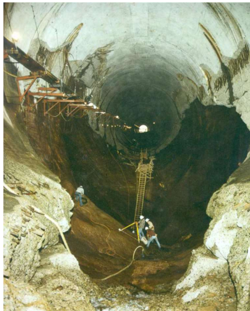
Figura 2.4. Daños por cavitación en el túnel de la presa Glen Canyon (Falvey, 1990)
