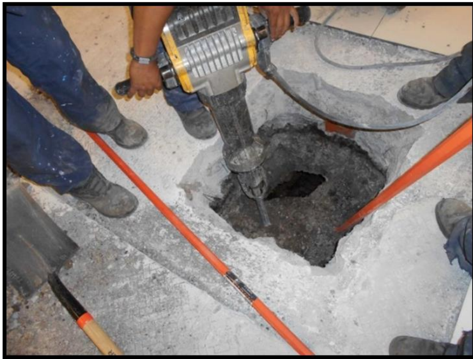
Figura 3.22 Trabajos de demolición en piso de concreto en Banda 8 de equipaje de la Terminal 1. Fuente: Estimación 8.
