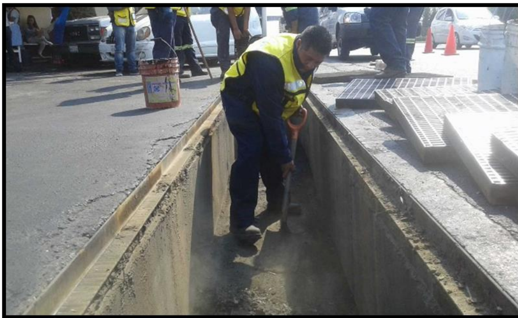
Figura 3.2. Limpieza por medios manuales de rejillas en calle Capitán Piloto Aviador Carlos León. Fuente Estimación 1.
