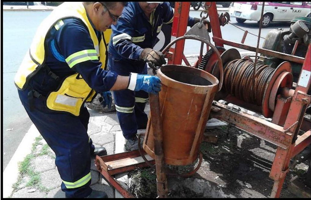
Figura 3.9. Dirigiendo la draga en el pozo mientras es jalada por el malacate al otro extremo. Fuente: Estimación 3
