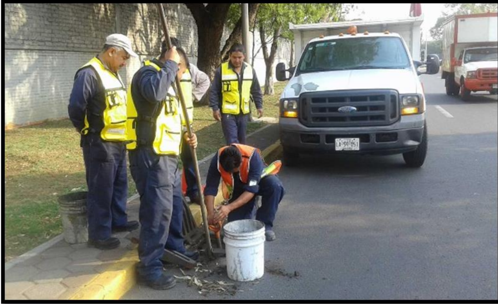
Figura 3.3. Limpieza por medios manuales de pozos pluviales en calle Sonora. Fuente Estimación 1.
