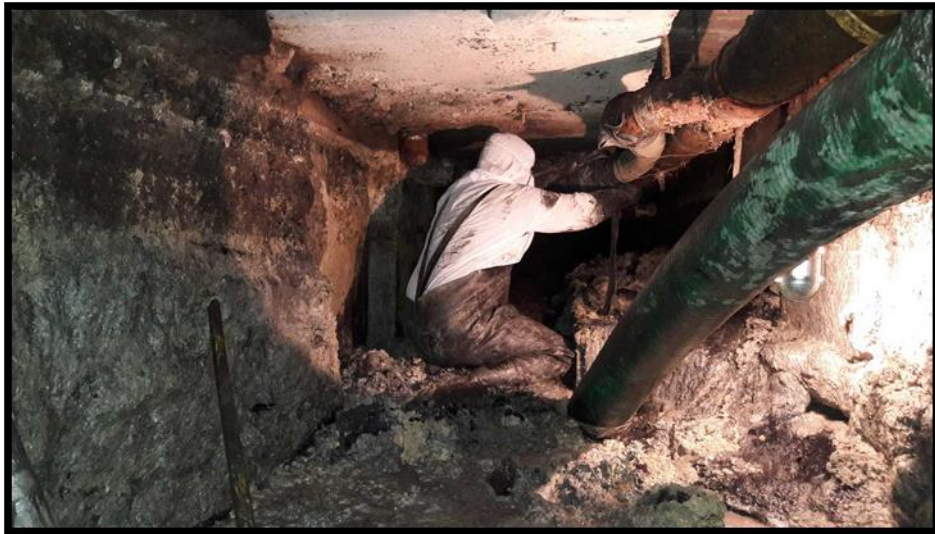
Figura 3.27. Trabajos de limpieza y reparación en trinchera de Banda 8 de equipaje de la Terminal 1. Fuente: Estimación 8.
