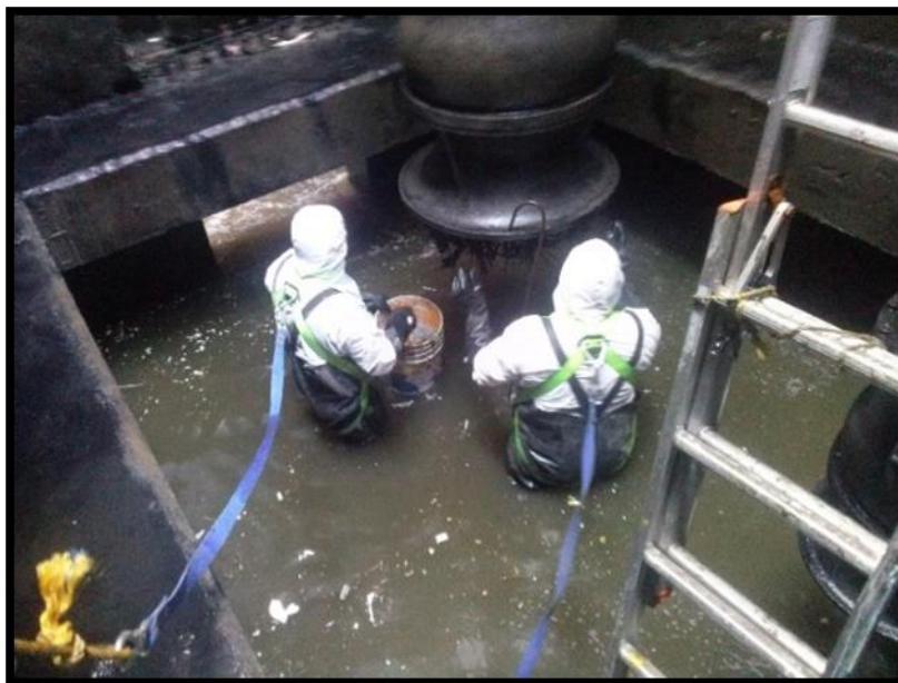
Figura 3.19. Equipo de seguridad para trabajos en cárcamos de bombeo. Fuente: Estimación 7
