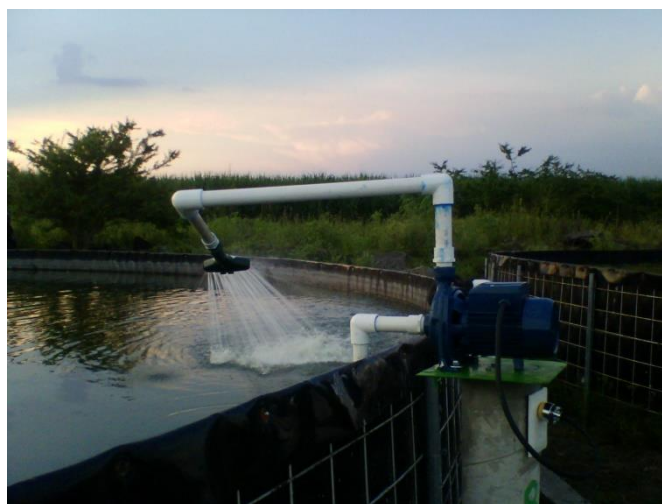
Fig. 12. Tecnificación de una granja piscícola: sistema de bombeo.
