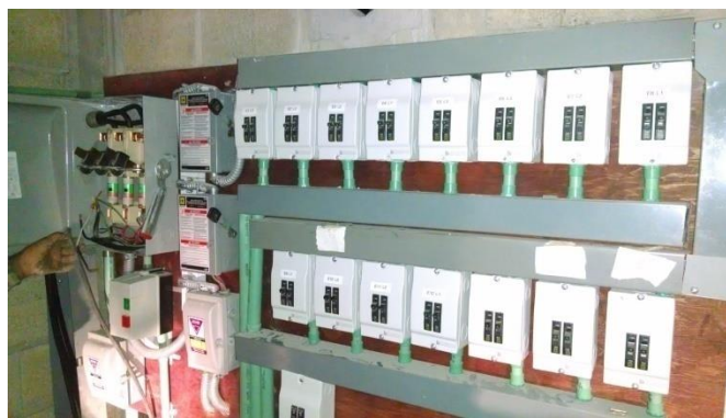
Fig. 11. Protecciones para el Centro de Control de Motores
