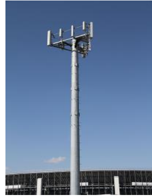
Figura 4.8 Torre tipo monopolo. [6]
