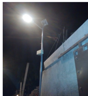
FIGURA 6.1.8 LUMINARIO PÚBLICO AUTÓNOMO SOLAR UBICADO EN EL MUNICIPIO DE IXTAPALUCA. ESTADO DE MÉXICO. SOFIA LEYVA. 2016
