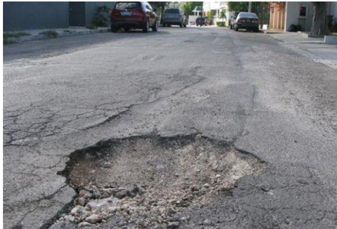
Figura 7. Desprendimiento de agregados.
