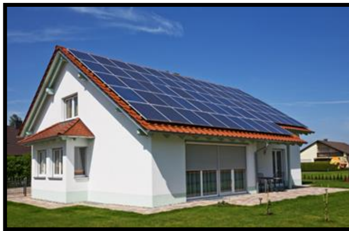
Figura 2.10 Sistema FV instalado en una vivienda 18
