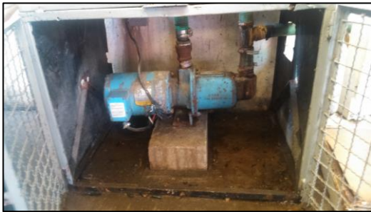
Bomba de alimentación
