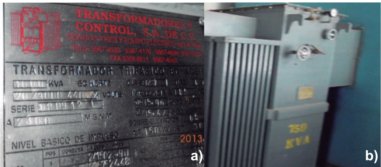
Figura 3.4: Datos de placa del a) TNS 2 de 1000 kVA y del b) TNS 1 de 750 kVA.
