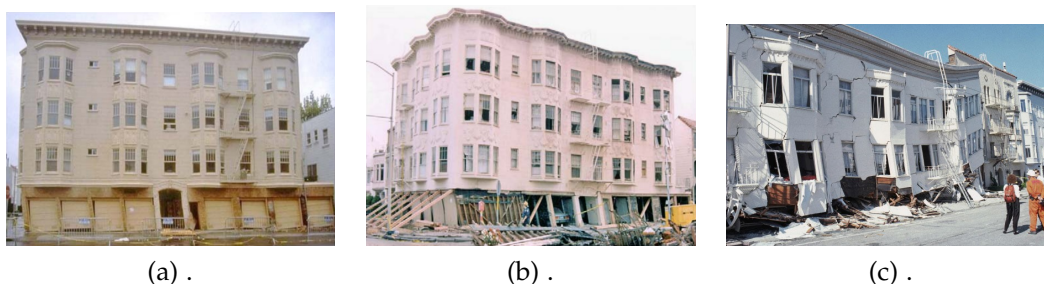
Figura 2: Edificios dañados por el sismo de Loma Prieta, en San Francisco. Fuente: Maison et al. (2012).
