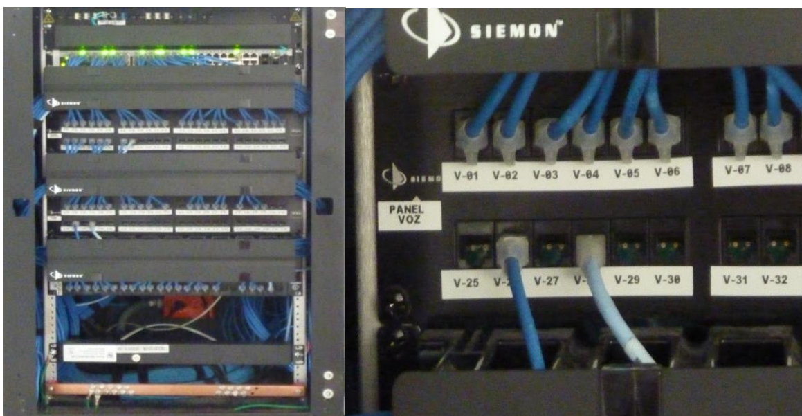
Fotografía 4.2.3f Gabinete terminado e interconectado con servicios identificados
