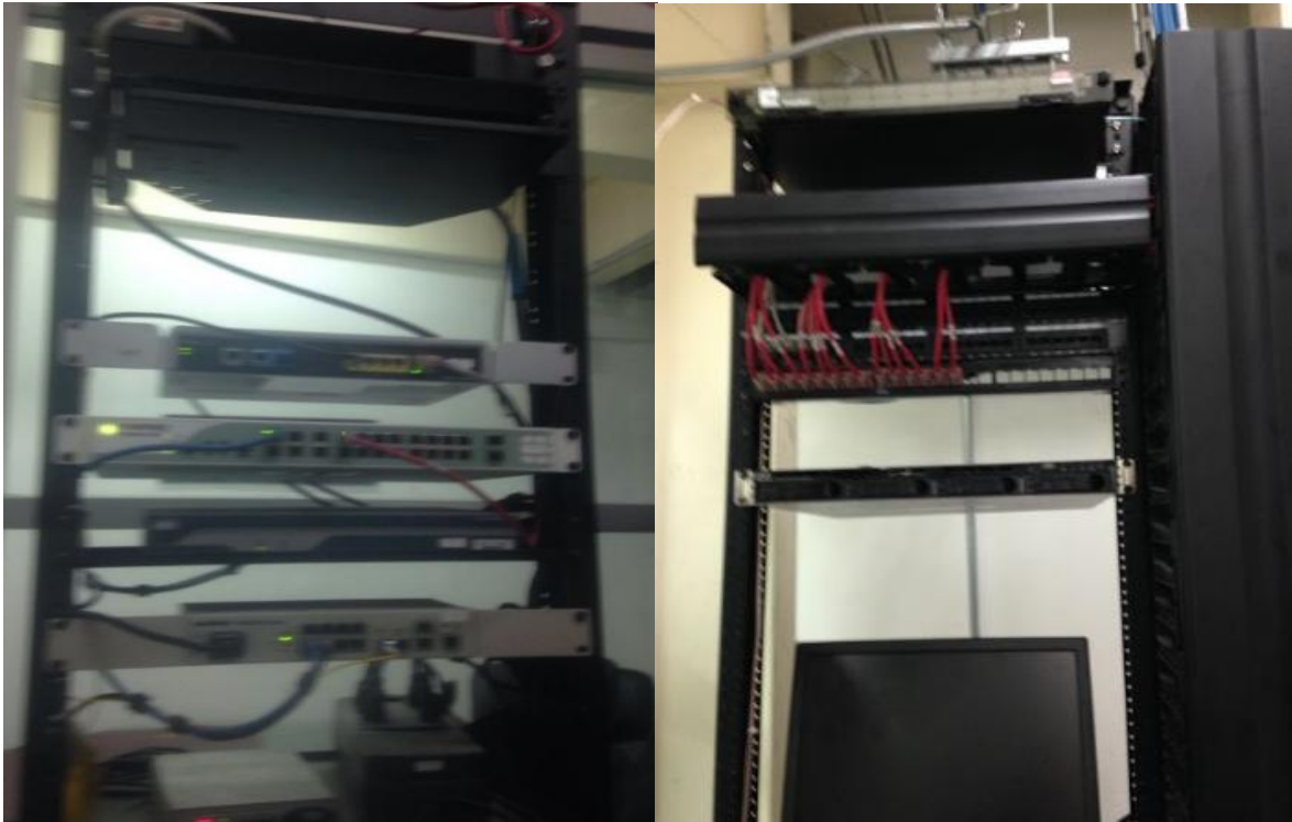
Fotografía 4.2.5g Racks con equipos de Alestra y Artco
