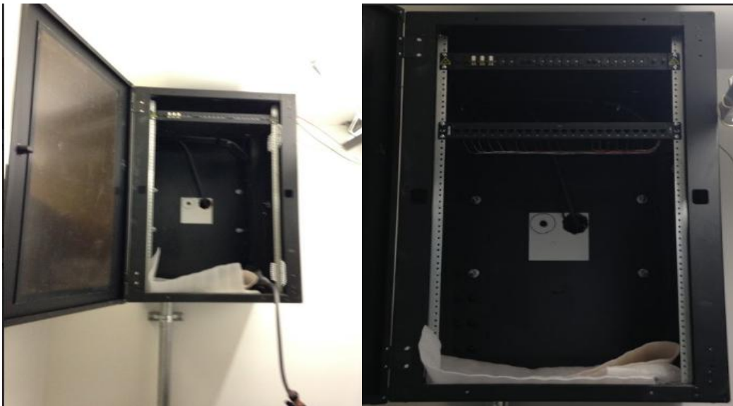
Fotografía 4.2.3c Instalación de switch, distribuidor y equipo de suministro eléctrico
