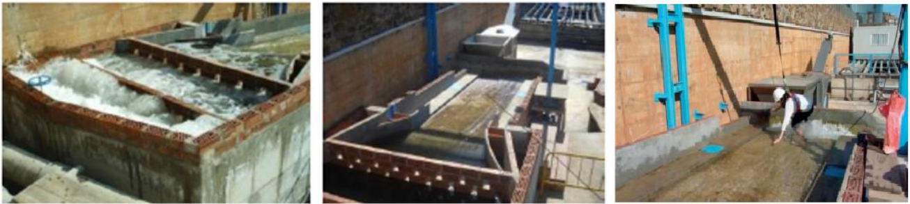
Figura 2-12 Módulo físico de calle, ejemplo de pérdida de estabilidad
