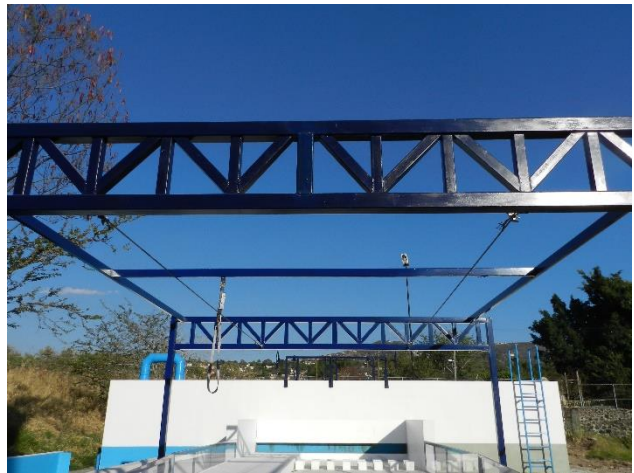
Figura 4-91 Cable de acero sujeto a estructura metálica
