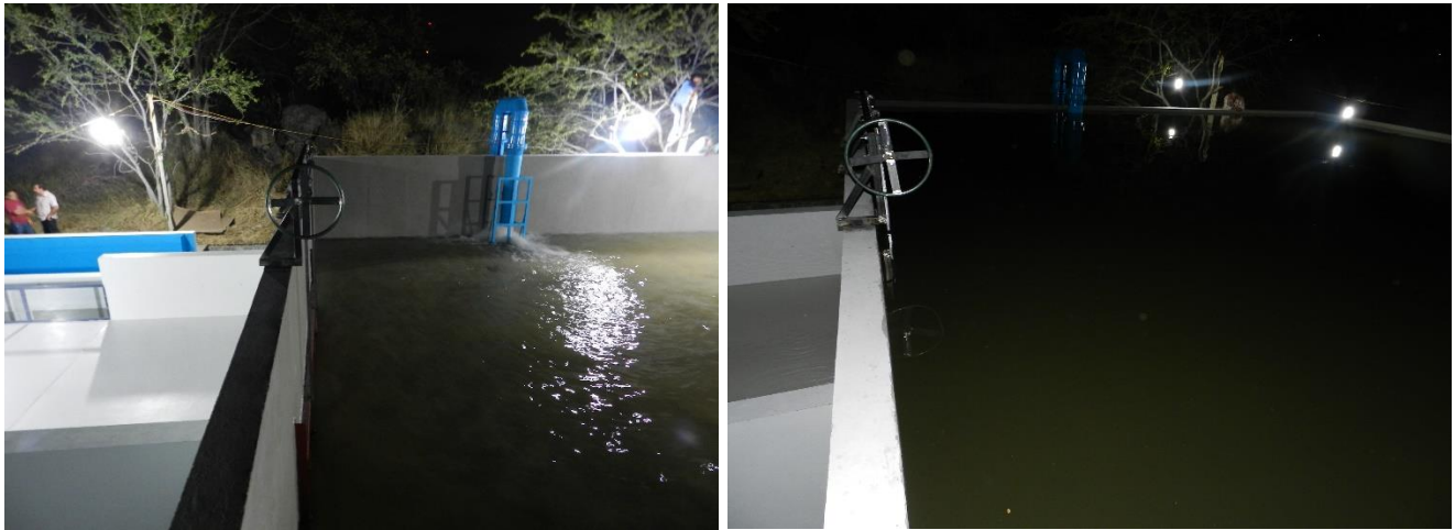
Figura 4-86 Primer llenado de tanque de almacenamiento
