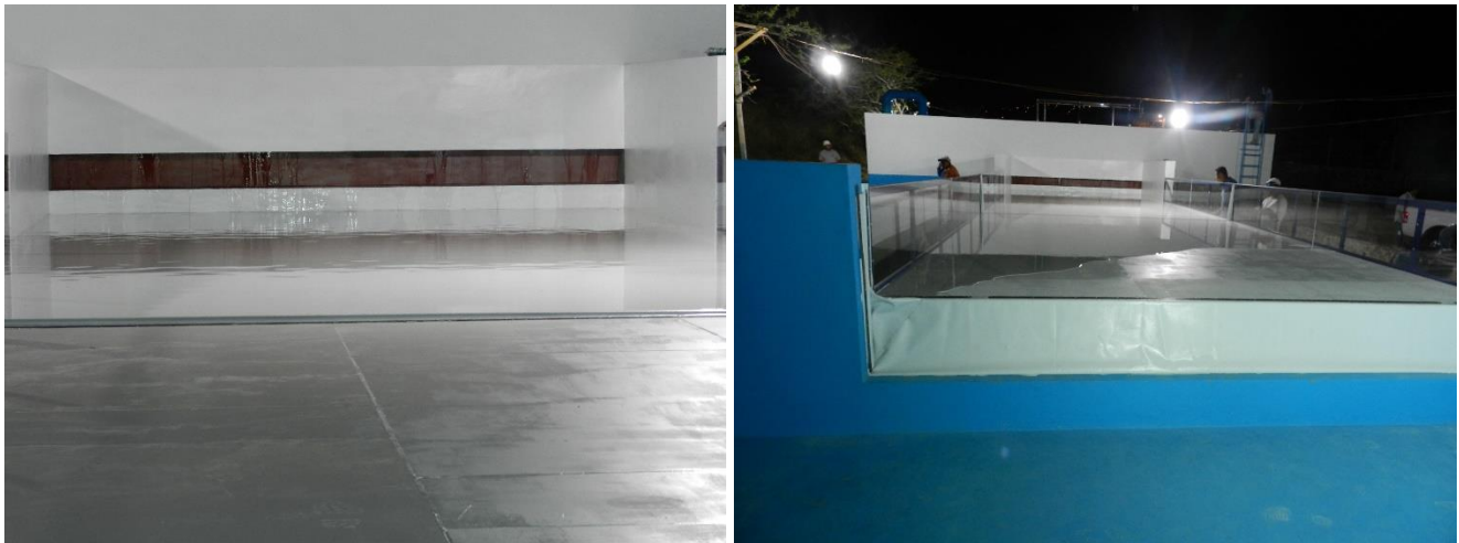
Figura 4-87 Filtración en la compuerta durante inspección de hermeticidad
