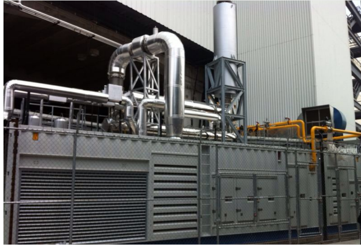
Figura 6.8: Vista general de la unidad generadora.
