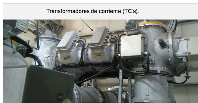
Figura 5.13: Ubicación de los transformadores de corriente en la subestación aislada en gas SF_6 .
