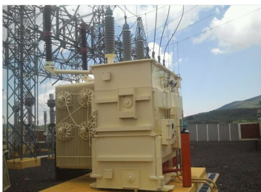
Figura 4.9: Vista del transformador en estudio.
