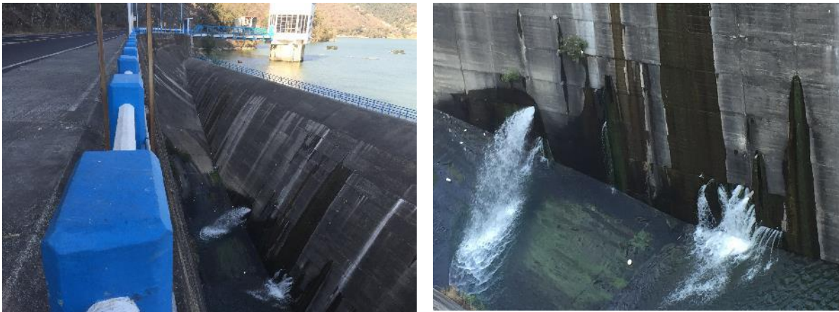
Figura 1.4 Filtración a través de las juntas de concreto en la Presa Valle de Bravo. Elaboración propia (2016).
