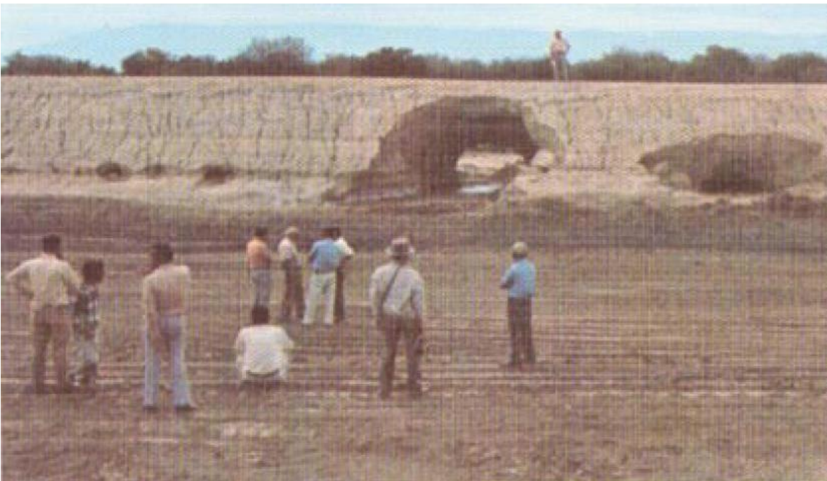
Figura 3.2 Vista aguas abajo de las fallas por tubificación presentadas en la cortina de la presa “La Escondida” en Tamaulipas. CFE-IIUNAM (2015).
