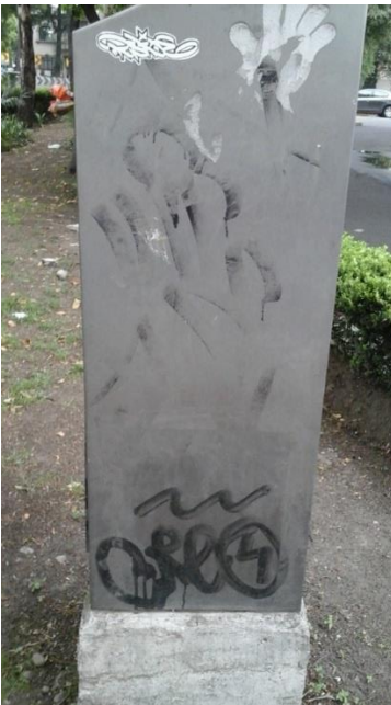
UNIDAD DE CONTROL
