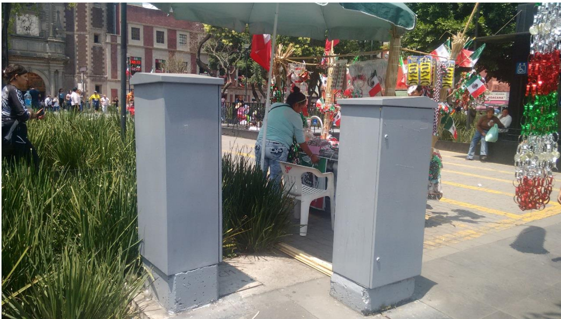
UNIDAD DE CONTROL
