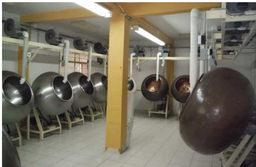
Ilustración 28 – Bombos con ventilación forzada.
