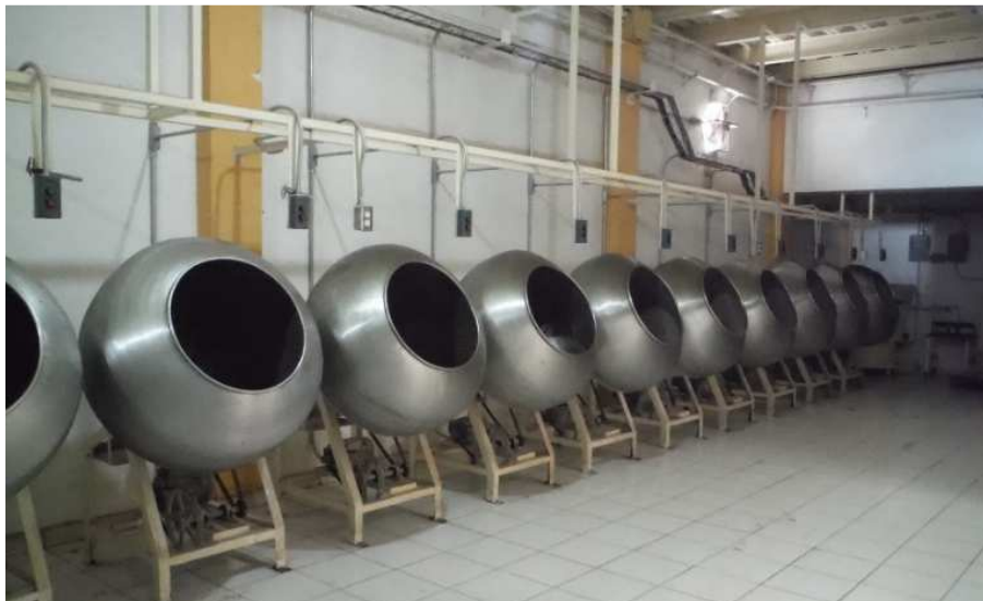
Ilustración 26 – Bombos con motor eléctrico de 1 HP
