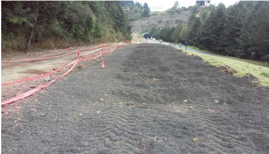
Imagen 4: Cama de Frenado de la Rampa de Emergencia
