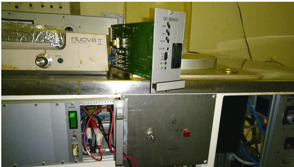
Figura 37. Sistema de deposición descompuesto
