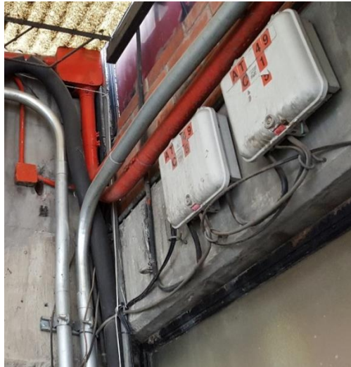
Fotografía 10 Cajas de abonado de las líneas telefónicas, instaladas por el proveedor (Telmex)
