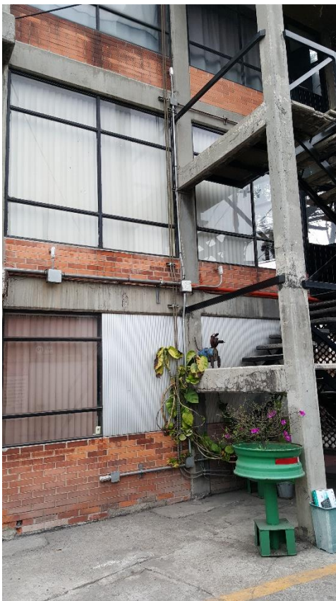
Fotografía 16 Canalización planta baja, primer piso, segundo piso
