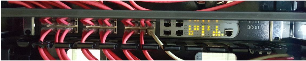
Fotografía 5 Swich 3COM de 24 puertos montado sobre el rack
