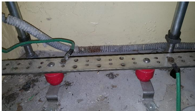
Fotografía 3 Conexiones a tierra dentro de la Sala de Telecomunicaciones
