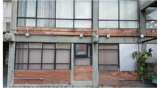
Fotografía 15 Canalización planta baja y primer piso
