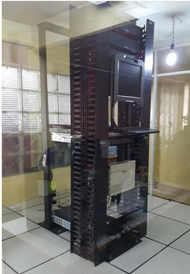
Fotografía 4 Rack instalado en la Sala de Telecomunicaciones
