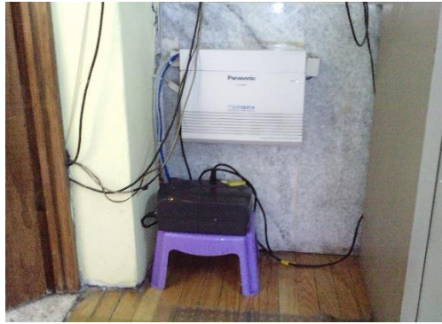
Figura 43 Instalación vieja de conmutador telefónico
