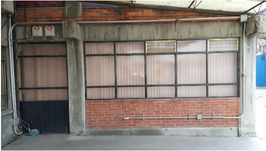
Fotografía 14 Canalización planta baja
