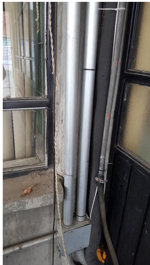
Fotografía 17 Registro de 5 salidas en la canalización
