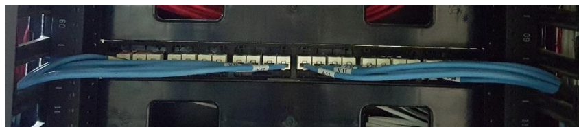
Fotografía 23 Patch panel, nodos de voz, vista trasera
