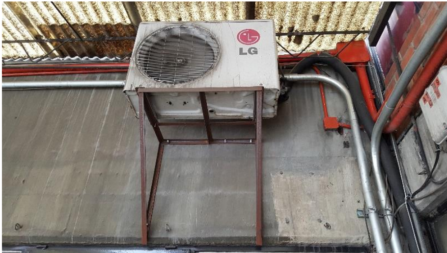
Fotografía 2 Instalación externa del aire acondicionado
