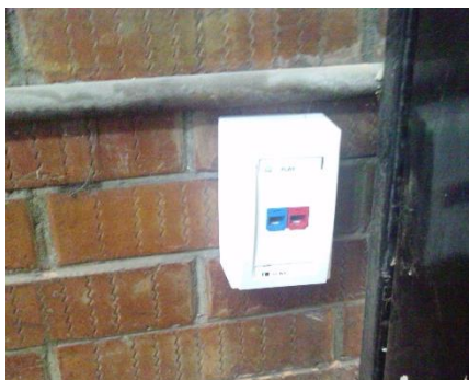
Fotografía 26 Nodos de voz y datos, sobre la pared
