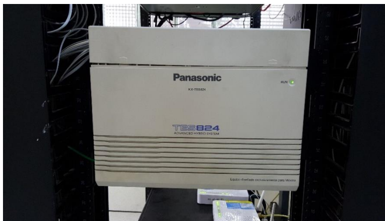
Fotografía 11 Conmutador telefónico modelo TES824 montado sobre el rack
