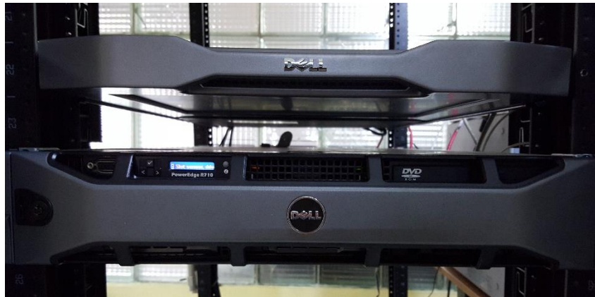
Fotografía 12 Servidor Dell y unidad KVM montados sobre rack
