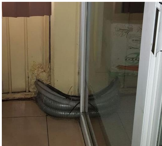
Fotografía 13 Salida y entrada de servicios en la Sala de Telecomunicaciones
