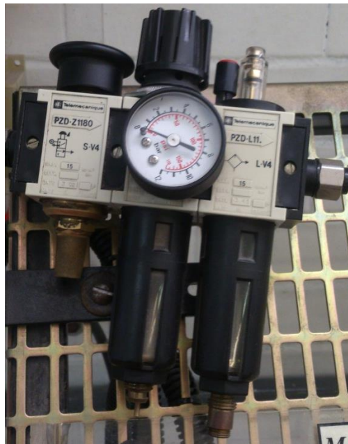
Imagen 20. Unidad de mantenimiento
