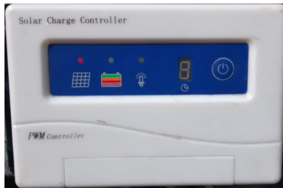
Imagen IV.3: Controlador de carga solar
