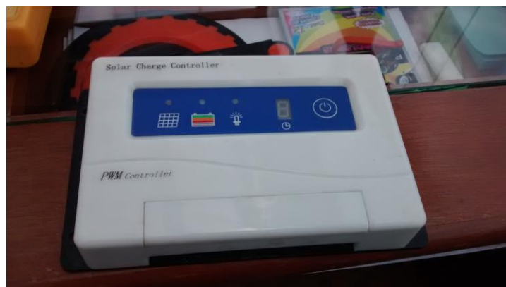
Imagen 7 Controlador solar MASS POWER
