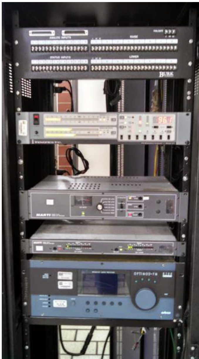
Figura 24. Rack en donde se ubicará el servidor.
